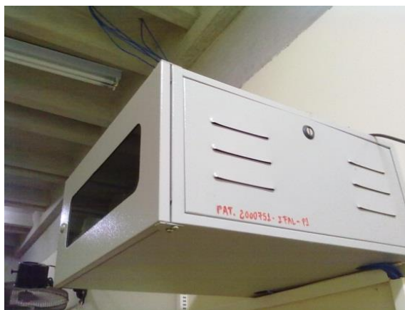
Figura 22 - Rack atual de distribuição do bloco de ensino. (Fonte: Autor.)
