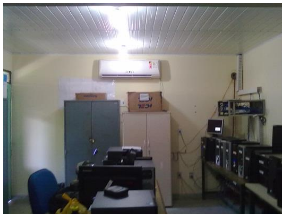
Figura 19 - Local da infraestrutura de telecomunicações. (Fonte: Autor.)
