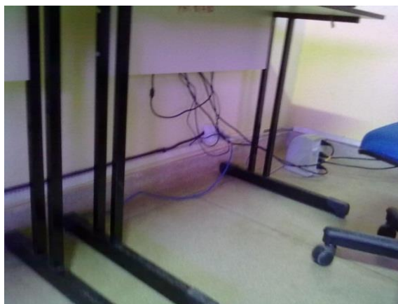
Figura 21 - Conectorização atual das estações. (Fonte: Autor.)
