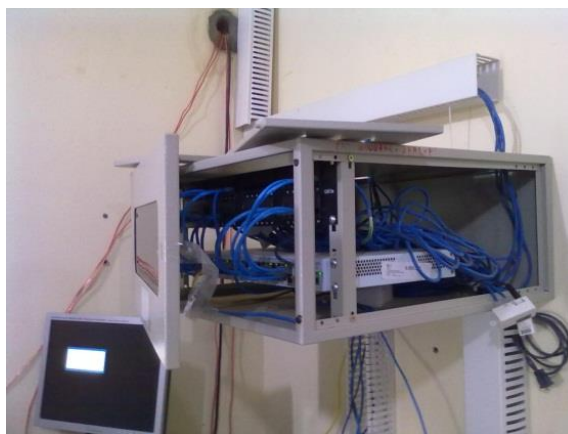
Figura 20 - Rack principal de distribuição. (Fonte: Autor.)
