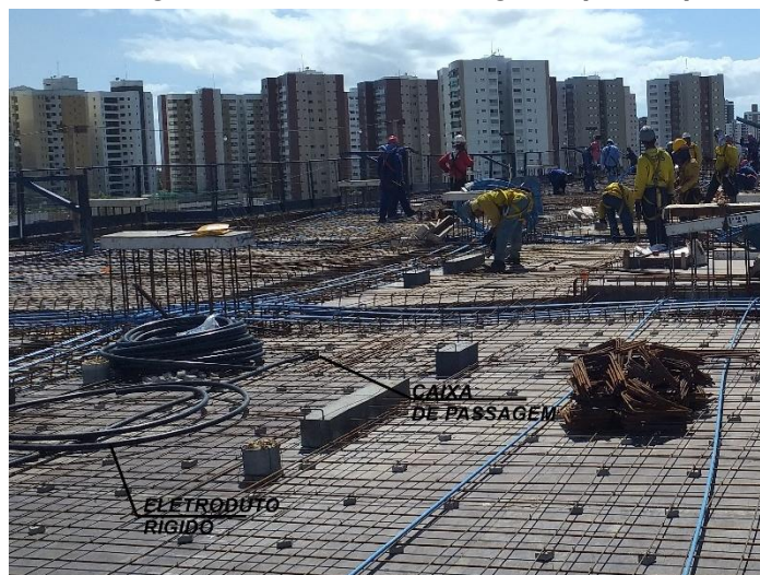
Fotografia 4.6 - Eletrodutos rígidos (Obra A)
