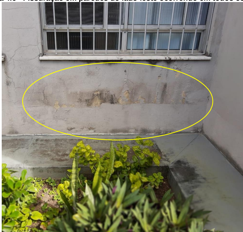
Figura 4.6 - Fissuração em paredes do lado leste ocorrendo em todos os blocos
