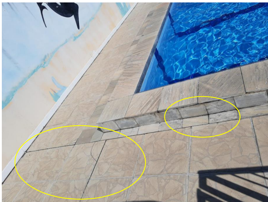
Figura 4.4 - Deficiência no rejuntamento na área da piscina
