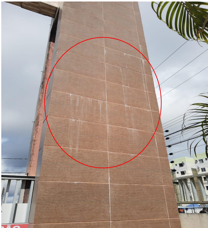
Figura 4.3 - Eflorescência nos revestimentos cerâmicos entrada do Condomínio
