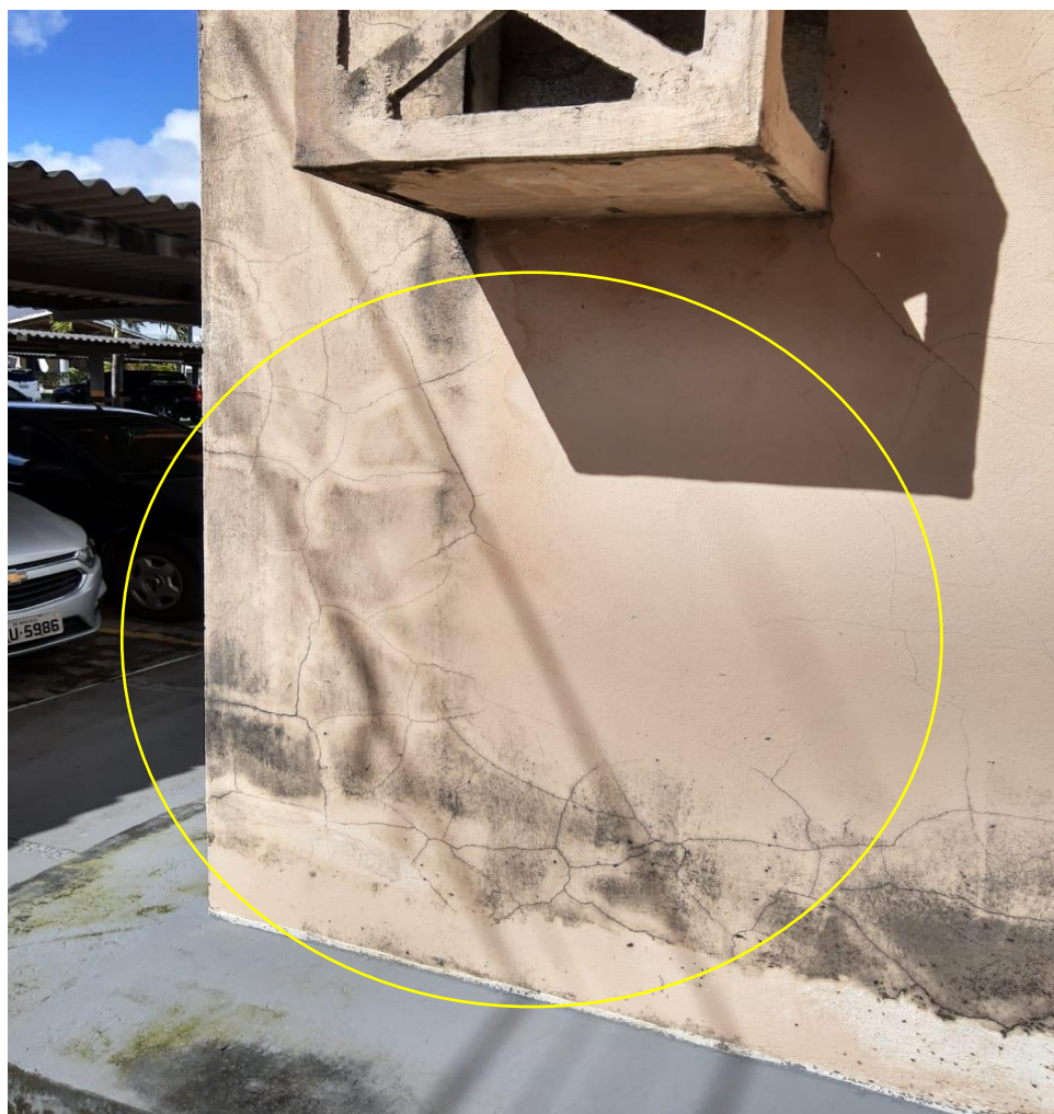
Figura 4.5 - Fissuração em paredes do lado sul ocorrendo em todos os blocos
