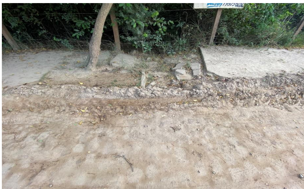
Figura 29: Obstruindo da vala de passagem de água para terrenos de detenção.
