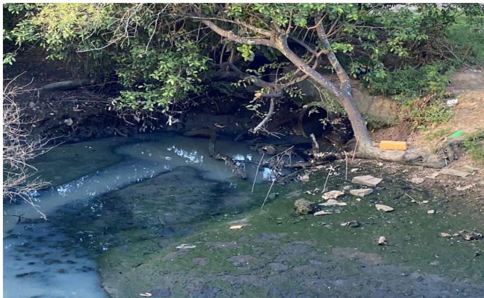
Figura 35: Tubulação de desague das águas do bairro afogada devido a quantidade de material assoreado no Rio Poxim.
