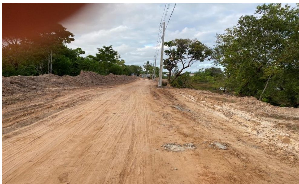
Figura 46: Desmatamento e aterramento da vegetação da Lagoa Doce.
