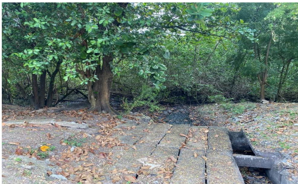
Figura 31: Galeria de rede de drenagem afogada devido a grande quantidade de material assoreado.
