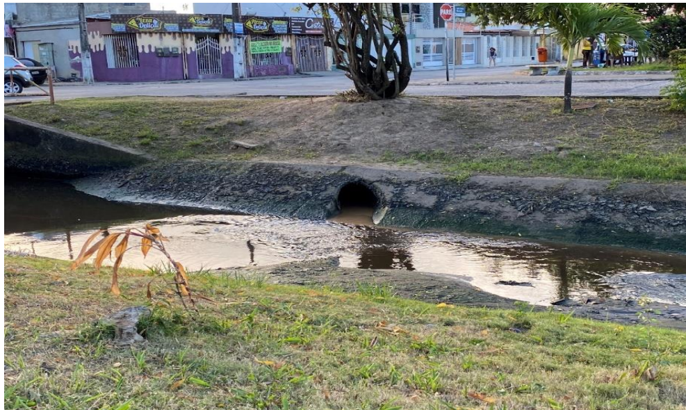
Figura 33: Tubulação de drenagem trabalhando ao nível do canal devido a grande quantidade de material assoreado do presente canal.
