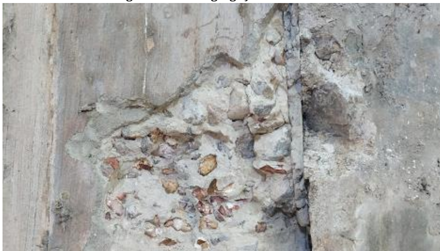
Figura 20 – Desagregação do concreto
