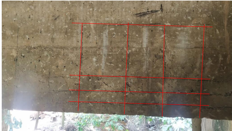
Figura 39 – Localização das Armaduras conforme ensaio de pacometria
