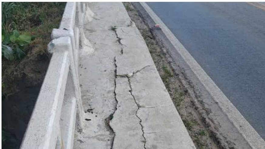
Figura 19 – Rachaduras no passeio
