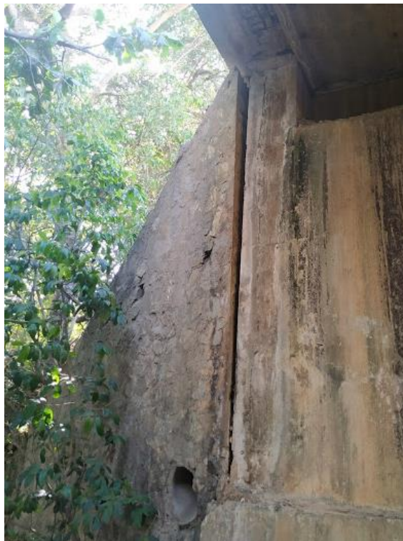
Figura 23 – Deslocamento do encontro
