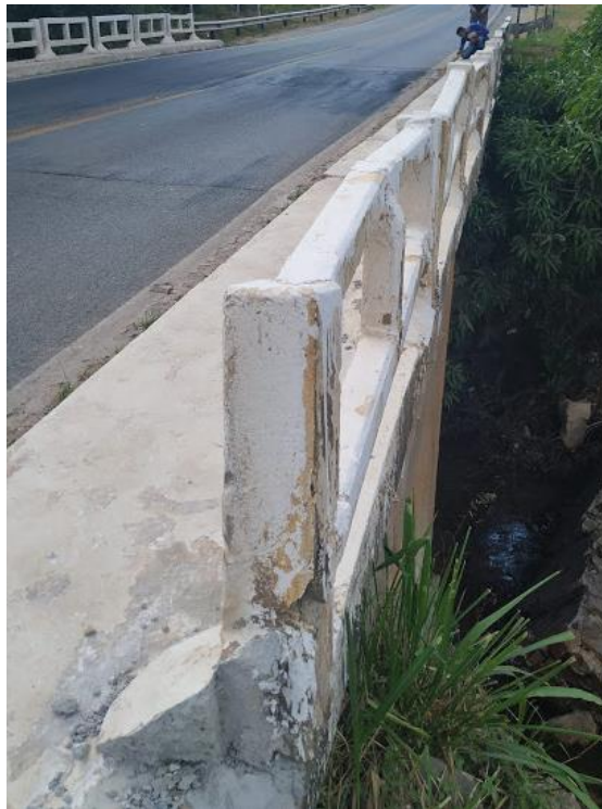
Figura 26 – Deterioração do guarda corpo
