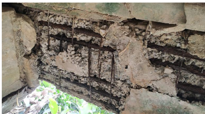
Figura 50 – Segregação do concreto do passeio
