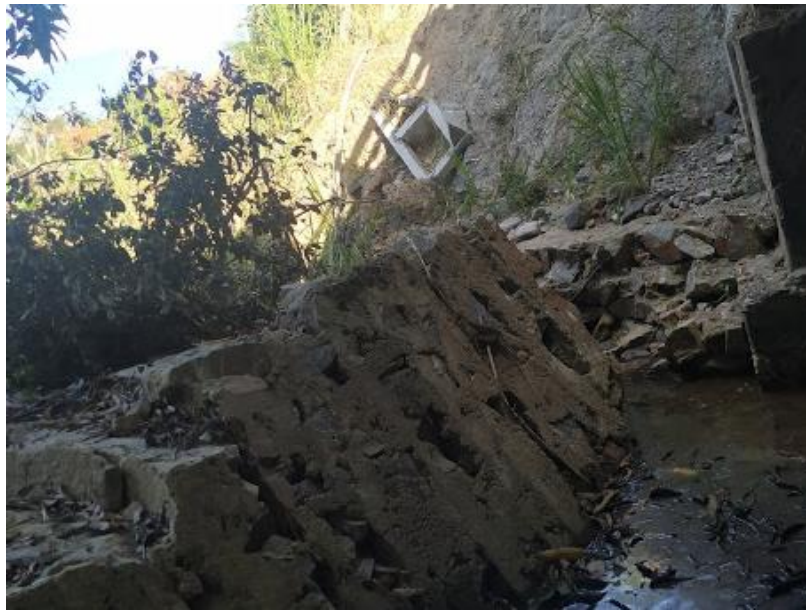
Figura 24 – Contenção do encontro caída
