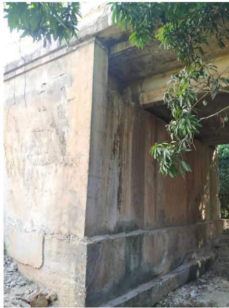
Figura 28 – Manchas de umidade
