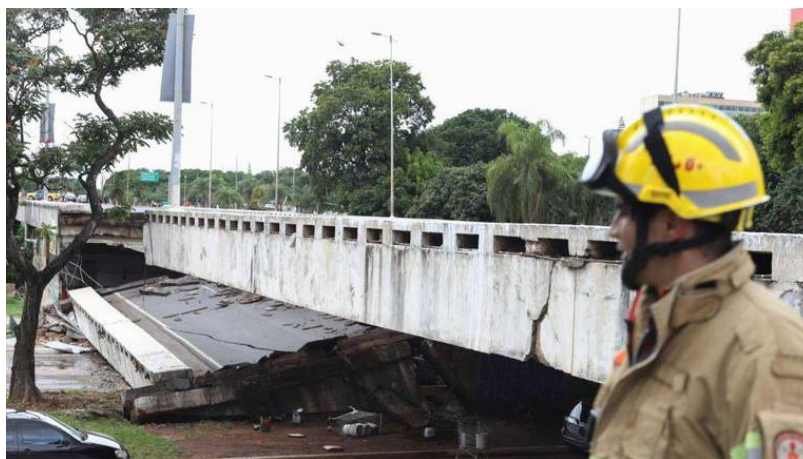
Figura 1 – Desabamento de parte do Eixão Sul no centro de Brasília
