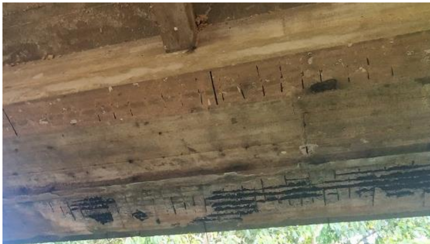
Figura 18 – Armaduras expostas e corroídas
