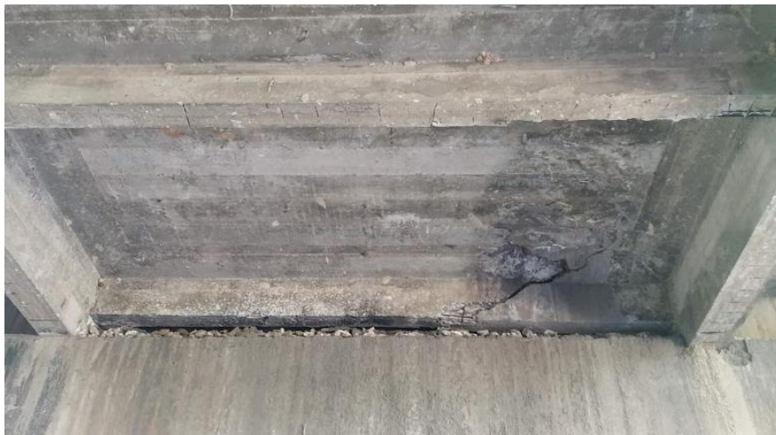
Figura 21 – Rachadura na laje e transversina
