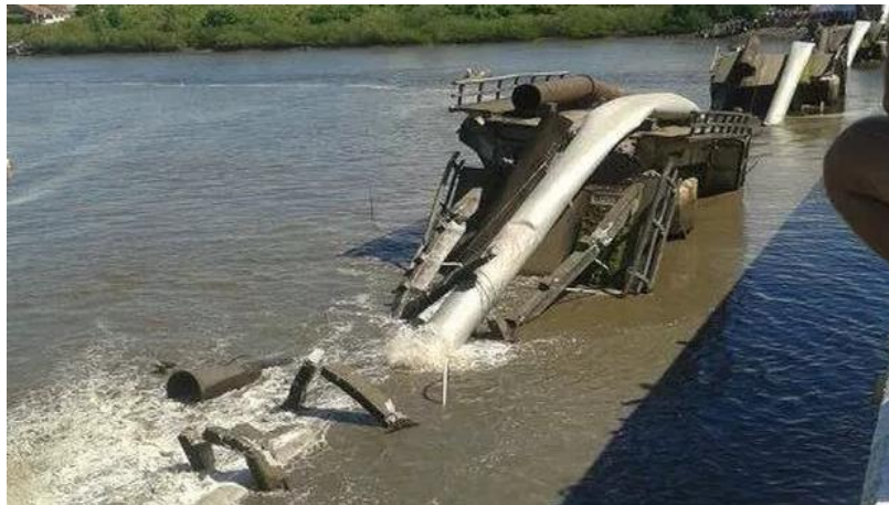
Figura 2 – Ponte desaba e rompe tubulação de água em Pedra Branca
