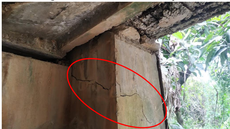
Figura 49 – Rachadura no encontro da ponte
