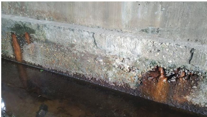
Figura 25 – Percolação de água no encontro
