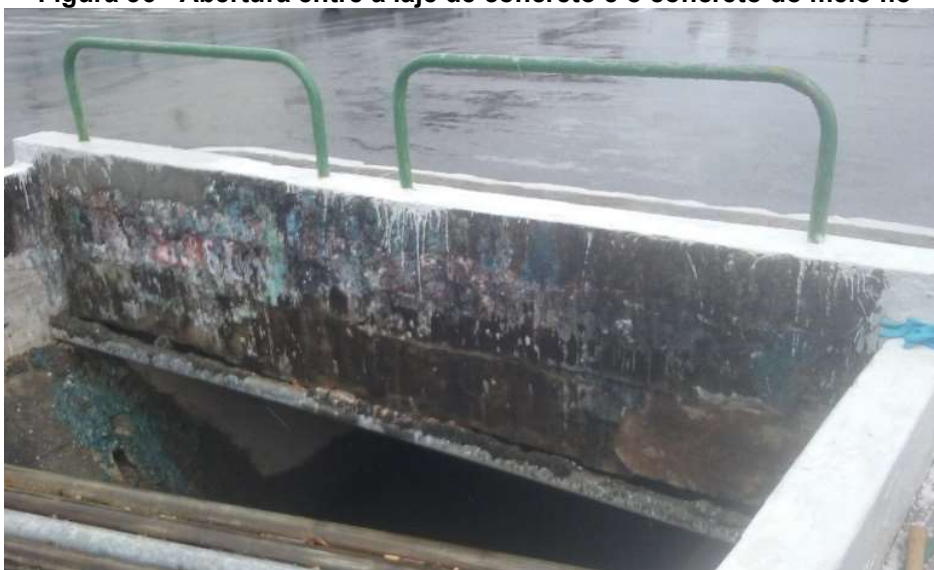
Figura 36 - Abertura entre a laje de concreto e o concreto do meio fio
