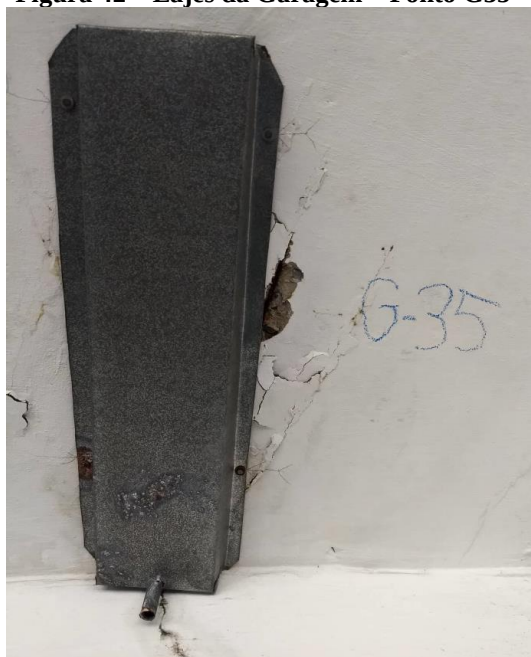
Figura 42 – Lajes da Garagem – Ponto G35
