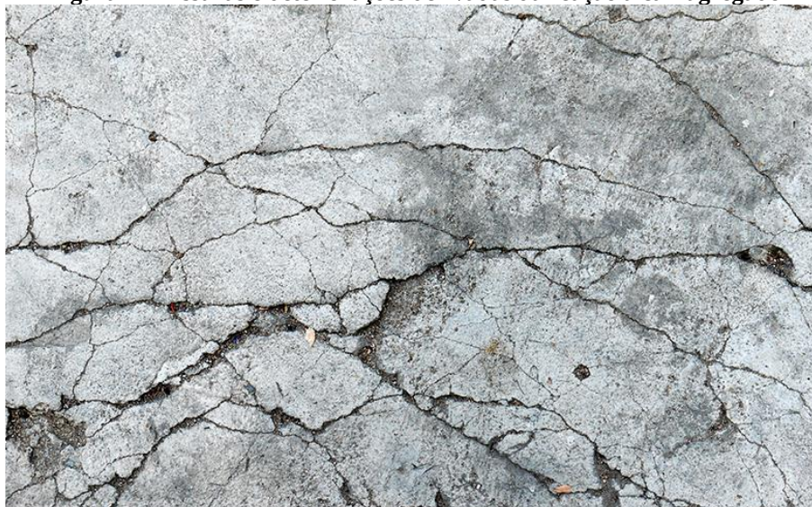
Figura 7 – Fissuras e deteriorações derivadas da reação álcali-agregado
