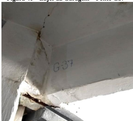
Figura 40 – Lajes da Garagem – Ponto G37
