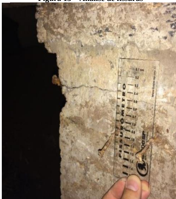
Figura 13 – Análise de fissuras
