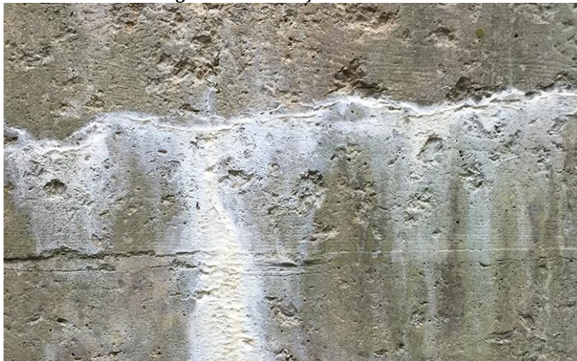
Figura 5 – Lixiviação do concreto
