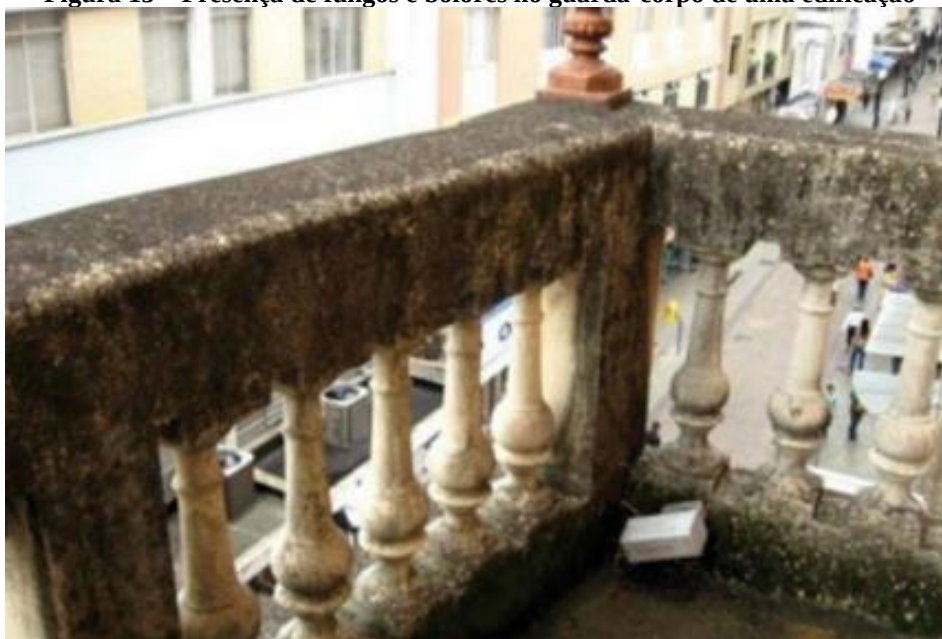
Figura 15 – Presença de fungos e bolores no guarda-corpo de uma edificação
