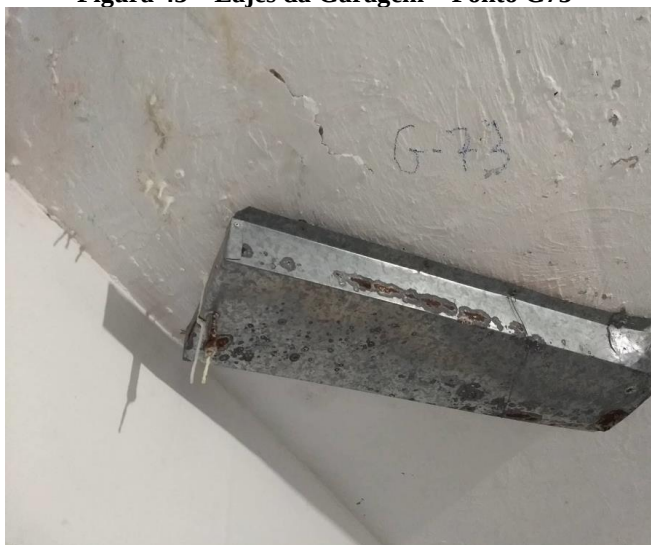
Figura 43 – Lajes da Garagem – Ponto G73
