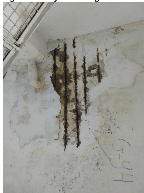
Figura 45 – Lajes da Garagem – Ponto G94
