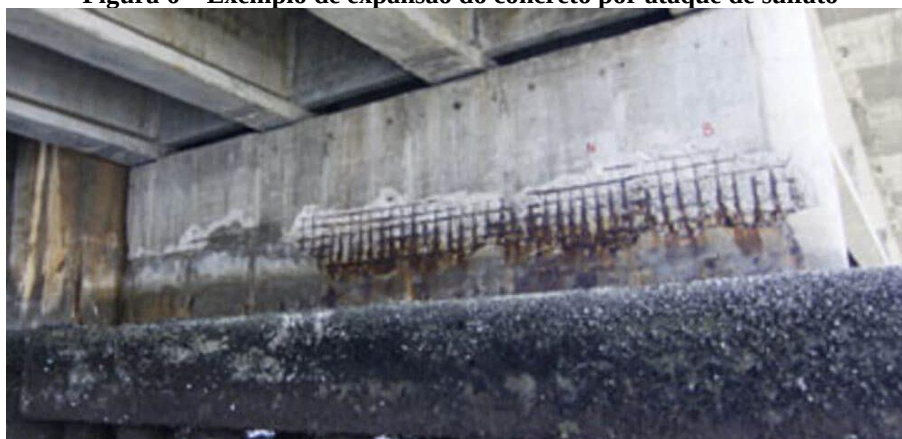
Figura 6 – Exemplo de expansão do concreto por ataque de sulfato
