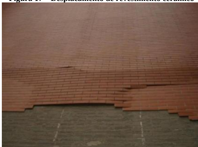
Figura 17 – Desplacamento de revestimento cerâmico
