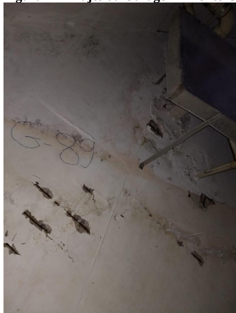
Figura 44 – Lajes da Garagem – Ponto G89
