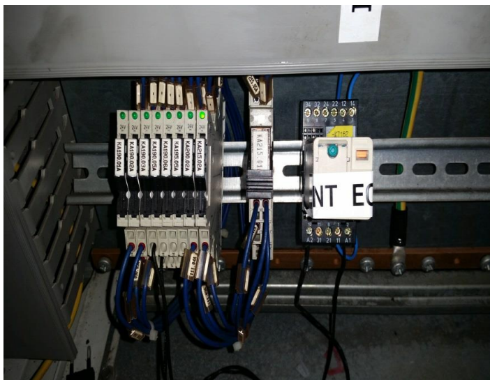
Figura 8: Relé de Acionamento do Forno
