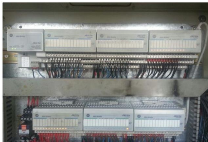
FIGURA 3: Rack de Flex I/O
