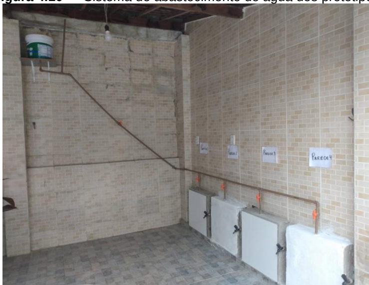
Figura 4.10 — Sistema de abastecimento de água dos protótipos.
