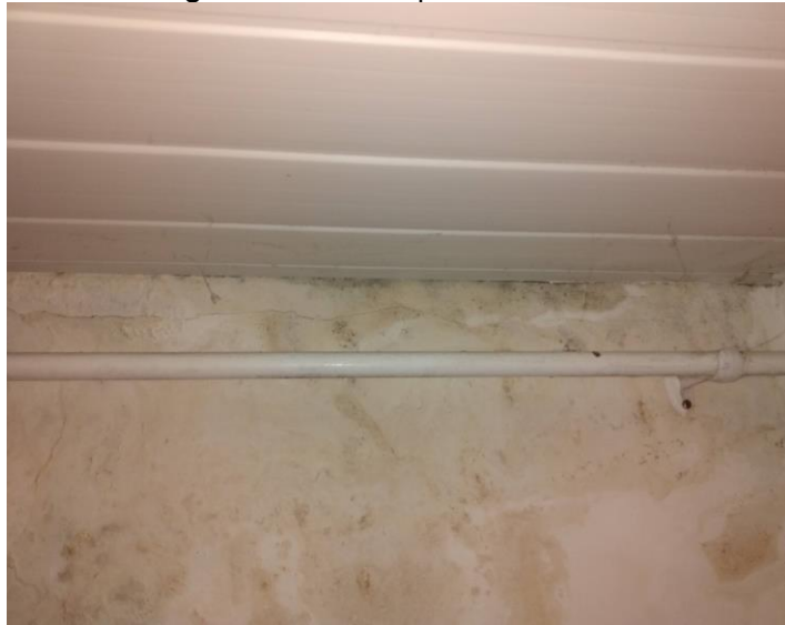
Figura 3.4 — Mofo próximo ao forro.
