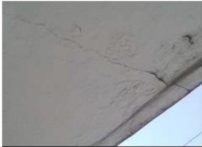
Figura 10: Fissura em marquise
