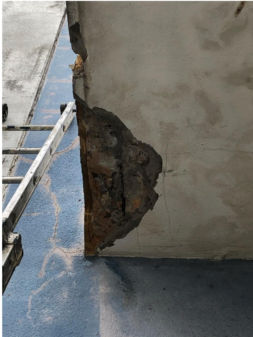
Figura 19: Corrosão na marquise da UFS
