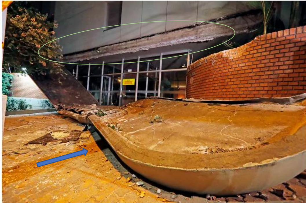
Figura 14: Marquise colapsada em São Paulo
