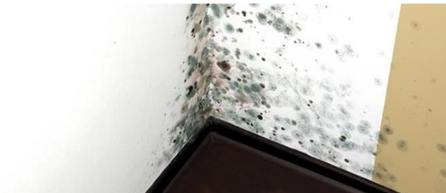
Figura 11: Bolor em estrutura de concreto
