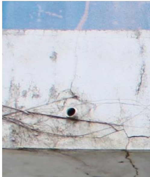
Figura 13: Fotografia evidenciando drenagem insuficiente na marquise
