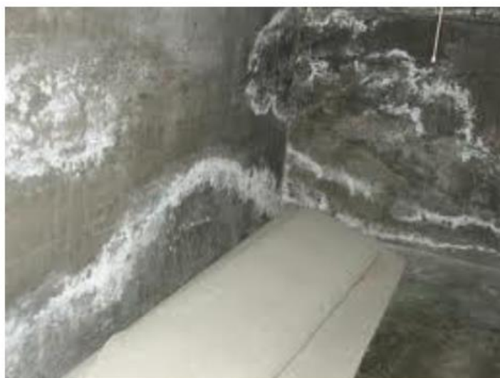
Figura 18: Eflorescência em parede
