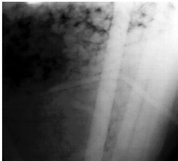
Figura 31: Gamagrafia evidenciando vazios no concreto
