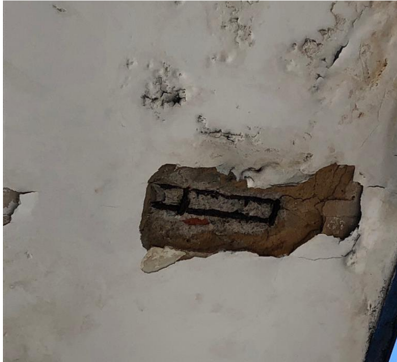
Figura 16: Marquise com fissuras em Aracaju
