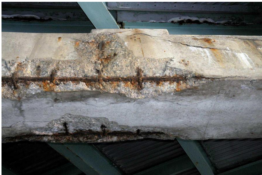
Figura 17: Peça estrutural de concreto armado que sofreu carbonatação
