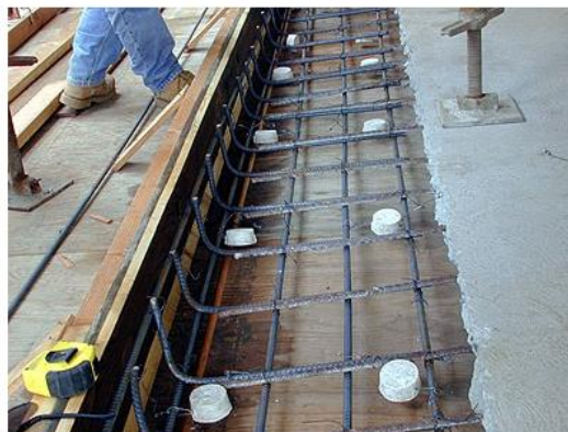
Figura 34: Utilização da pastilha de zinco para proteção catódica
