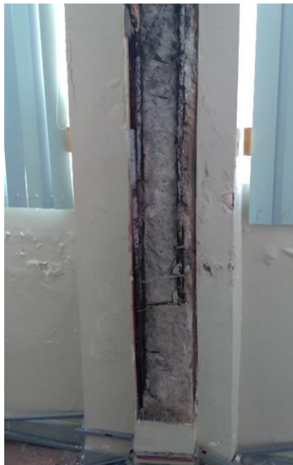
Figura 30 - Corrosão em pilar de fachada
