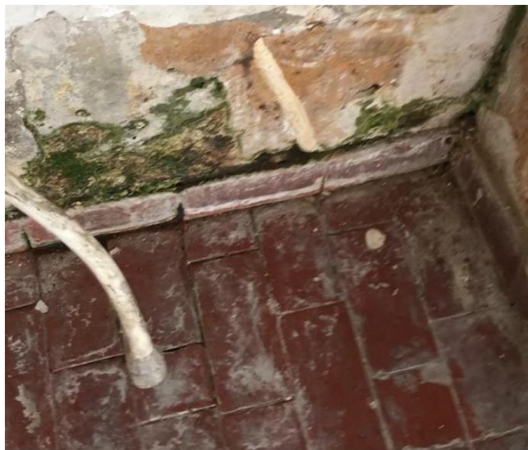
Figura 12 - Presença de mofo em alvenaria
