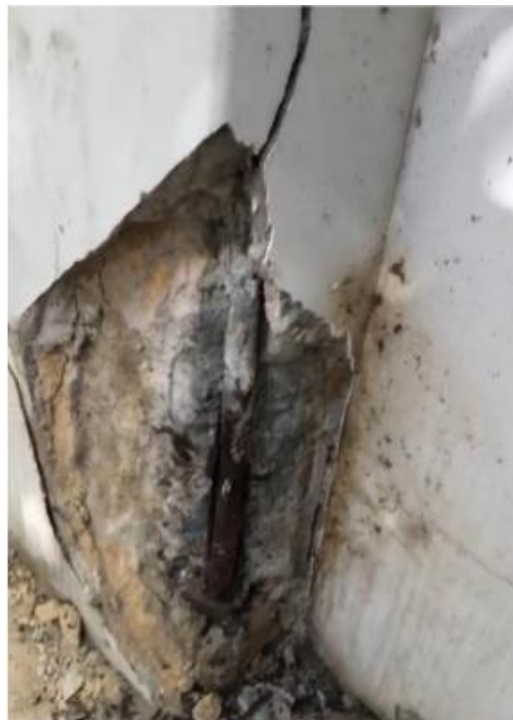
Figura 27 - Corrosão na armadura de pilar
