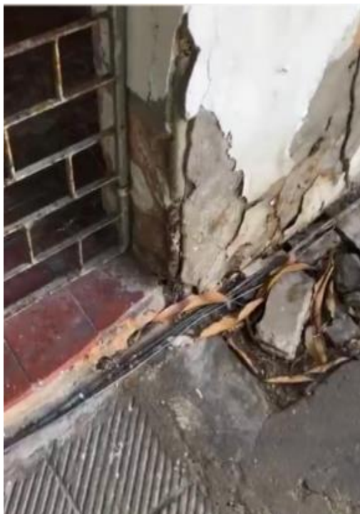
Figura 26 - Corrosão na armadura de pilar
