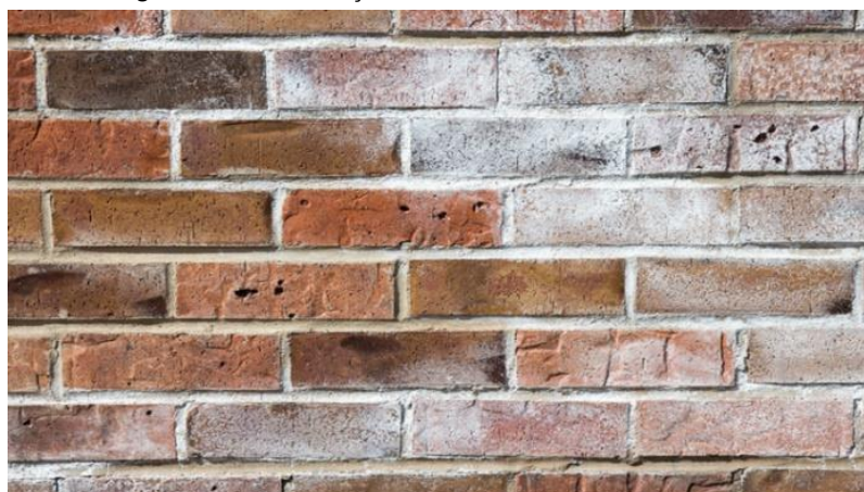
Figura 11 - Presença de eflorescência em alvenaria
