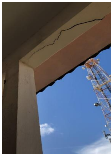
Figura 33 - Fissura em viga próximo de pilar
