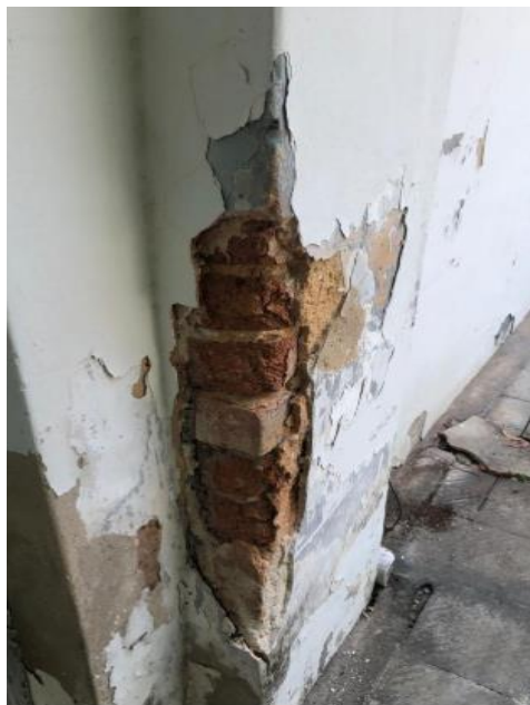
Figura 20 - Presença de EPU em cerâmica
