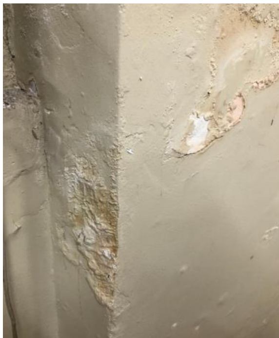
Figura 23 – Presença de eflorescência em parede revestida
