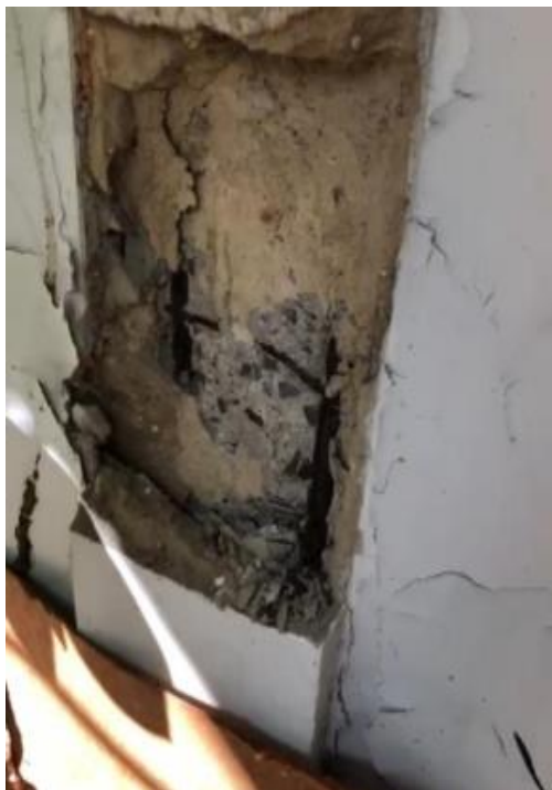
Figura 28 - Corrosão em armadura de pilar
