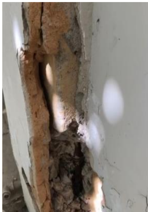
Figura 29 - Corrosão em armadura de pilar
