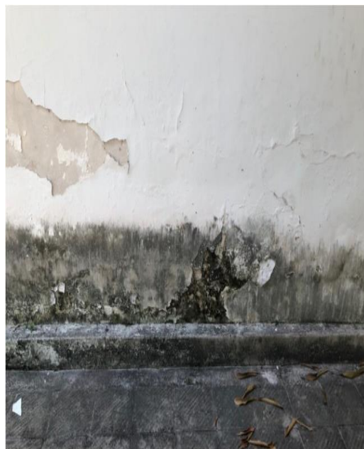
Figura 21 - Infiltração em alvenaria
