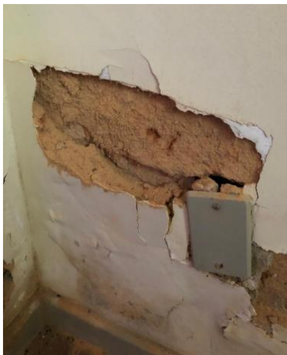
Figura 22 - Reboco desfarelante nos revestimentos de alvenarias
