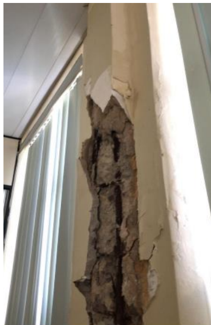
Figura 31 - Corrosão em pilar de fachada
