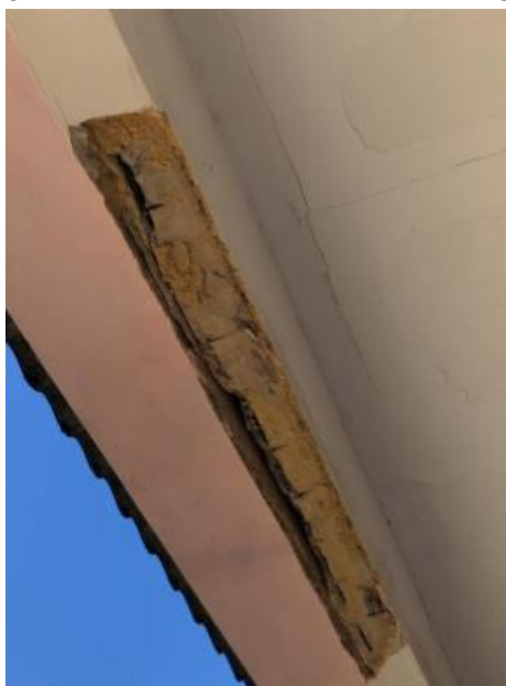
Figura 32 - Corrosão na armadura de viga
