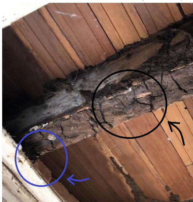
Figura 14 - Elemento estrutural de madeira sob ação de fungos apodrecedores
