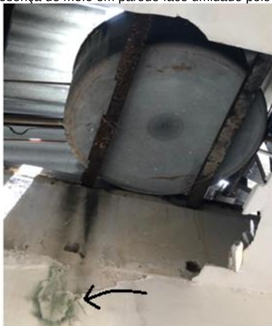
Figura 25 – Presença de mofo em parede face umidade pelo destelhamento
