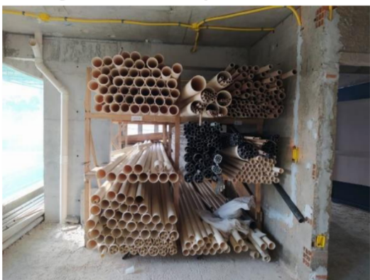
Fotografia 10 – Estoque de Tubos.
