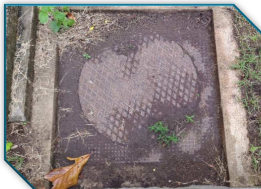
Figura 11 Caixa de inspeção de esgoto
