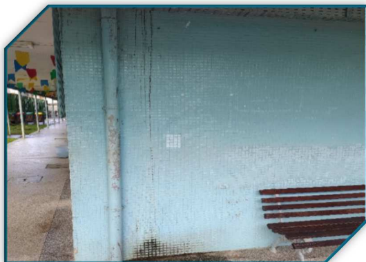
Figura 12 Condutor vertical de águas pluviais das lajes de cobertura
