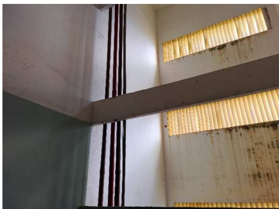
Figura 33 Tubulação de recalque e colunas de água fria, incêndio e extravasor: prédio 12.
