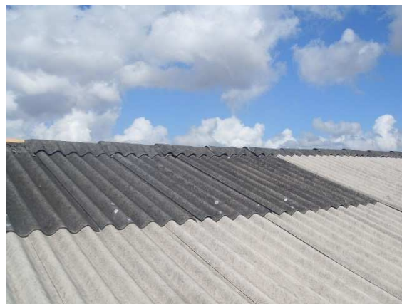
Figura 17 Água de telha de fibrocimento: prédio 04.
