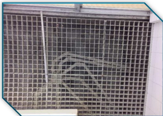
Figura 10 Banheiro - Caixa sifonada (desconector)
