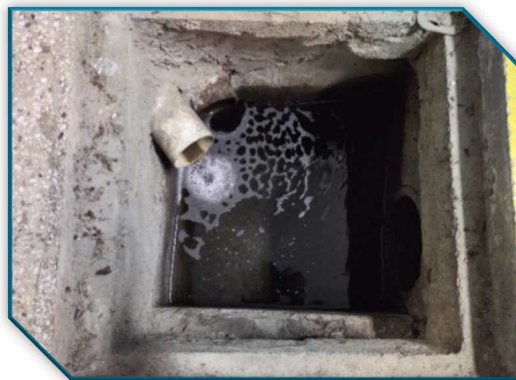
Figura 13 Caixa de passagem de águas pluviais
