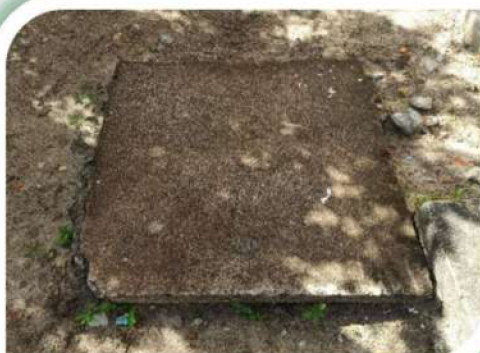
Figura 4: Caixa de passagem subterrânea.
