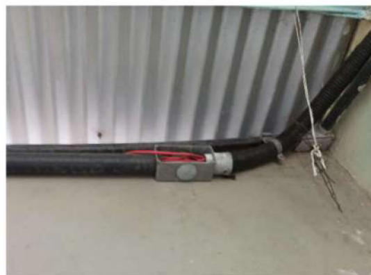
Figura 11 - Eletrodutos do ginásio poliesportivo.
