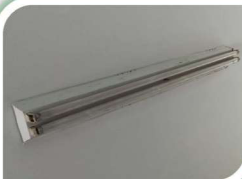
Figura 6: Luminária fluorescente do corredor.
