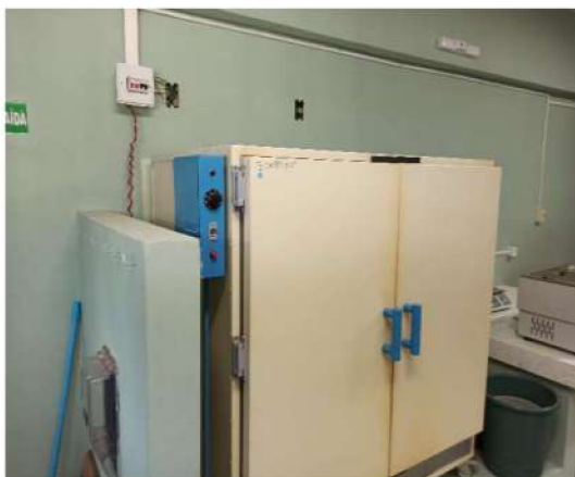
Figura 15 - Equipamentos de laboratório com tomadas de uso específico.
