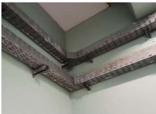
Figura 10 - Eletrocalhas do bloco Leyda Régis.
