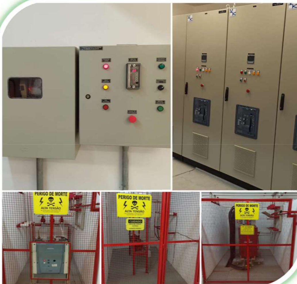
Figura 8: Componentes da subestação do campus.
