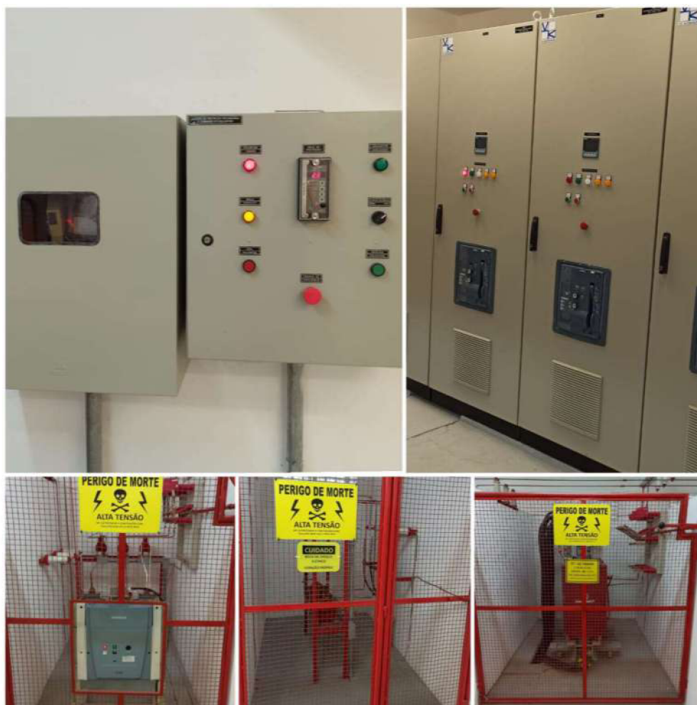
Figura 14 - Componentes da Subestação.
