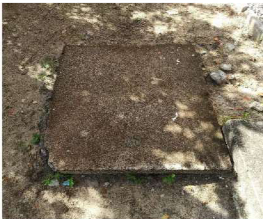
Figura 12 - Caixa de passagem subterrânea.
