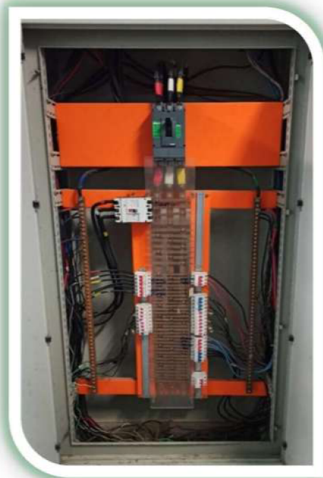
Figura 1: Quadro de distribuição geral.
