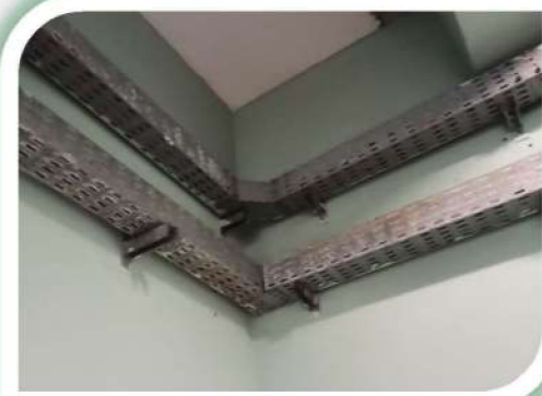
Figura 2: Eletrocalhas dos corredores.
