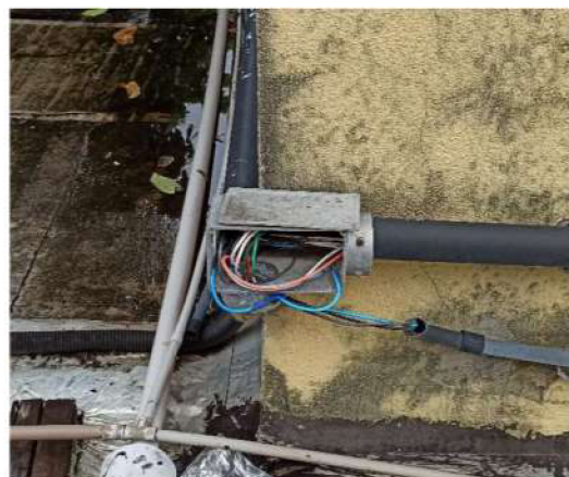
Figura 16 - Fiação de cobre (baixa tensão).
