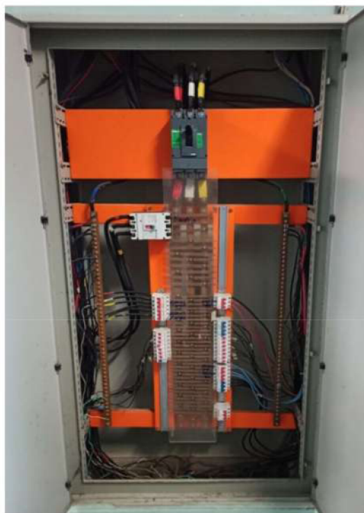
Figura 9 - Quadro de distribuição geral do bloco Leyda Régis.
