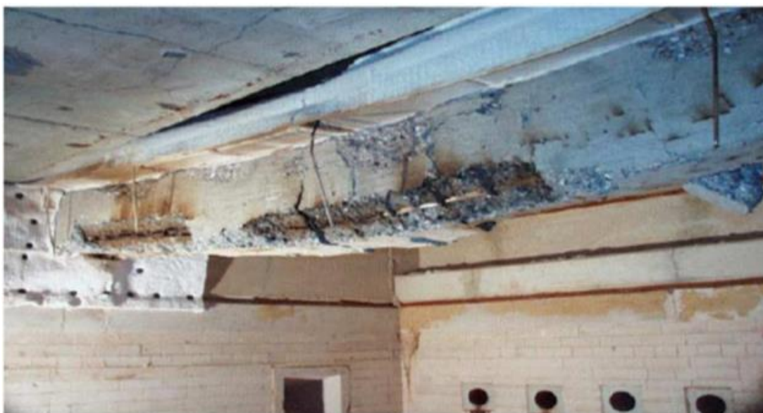
Figura 3.7 – Fenômeno do spalling em viga de concreto.
