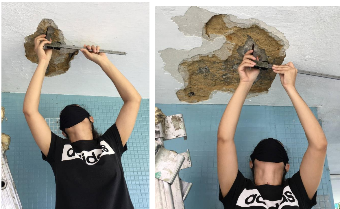
Figura 4.10 – Medição com o paquímetro nos pontos escarificados existentes.
