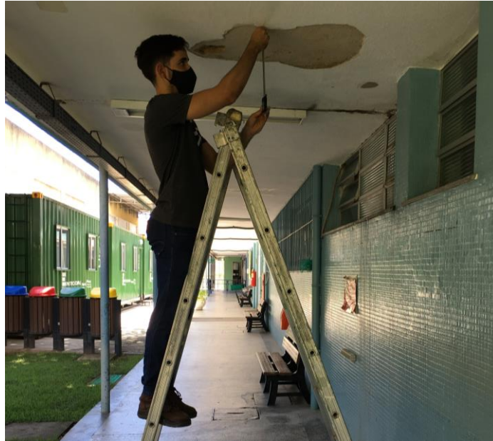
Figura 32 – Análise de ponto existente de escarificação na marquise da entrada principal.
