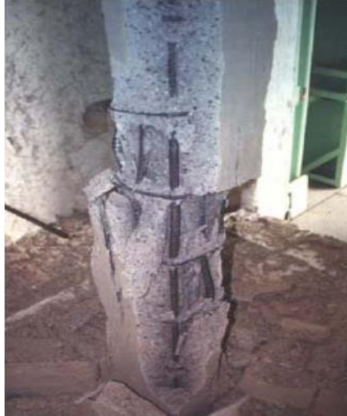
Figura 4 – Fenômeno spalling ocorrido em um pilar de concreto armado.
