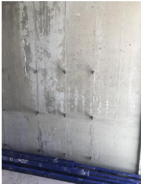
Figura 37 - Paredes desformadas com presença de faquetas
