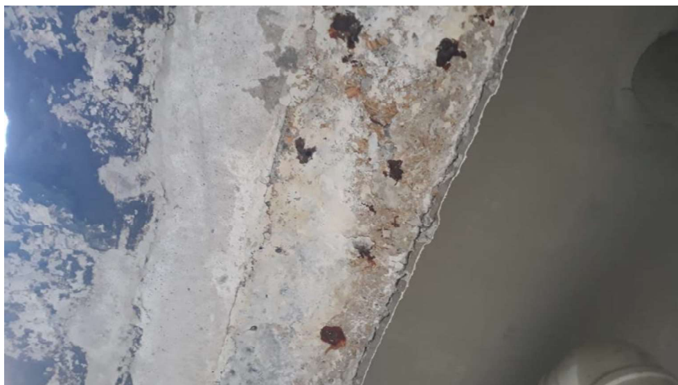
Figura 23 – Vista inferior de uma região da parede
