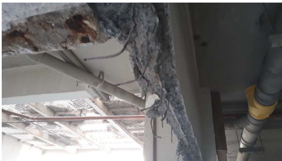
Figura 22 – Vista inferior da piscina ruída
