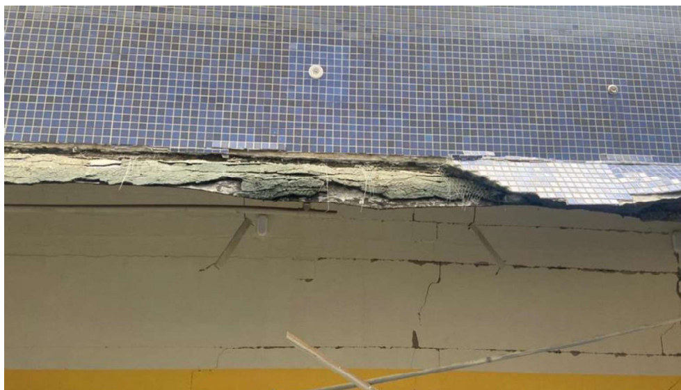
Figura 19 – Vista lateral da piscina ruída
