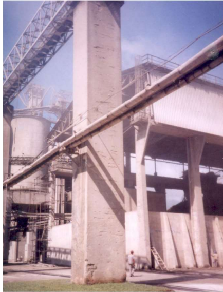
Figura 16 -Corrosão generalizada, atinge pilar em zona industrial Fonte: Aguiar (2006)
