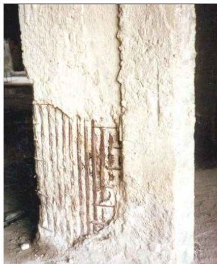
Figura 11 -Corrosão causada pela carbonatação Fonte: Aguiar (2006)
