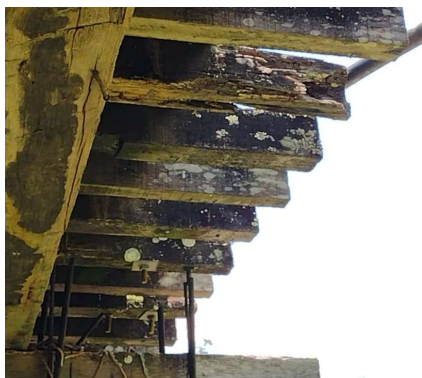
Figura 33 -Ataque de fungos empoladores Fonte: Próprio autor (2021)
