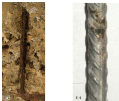
Figura 17 -Corrosão generalizada desencadeada pela carbonatação do concreto (a) e da corrosão puntiforme desencadeada pela ação dos íons cloreto (b) Fonte: Figueiredo e Meira (2013)
