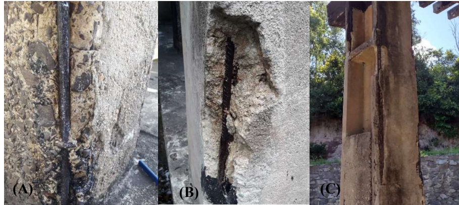
Figura 31 -Exposição de armadura e corrosão, pilar P11 (A), pilar P12 (B) e pilar P9 (C) Fonte: Próprio autor (2021)
