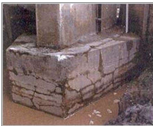
Figura 12 -Reação álcali-agregado em bloco de fundação Fonte: DNIT (2010)
