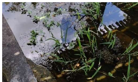
Figura 29 -Água parada entre sapata 04 e 05 Fonte: Próprio autor (2021)
