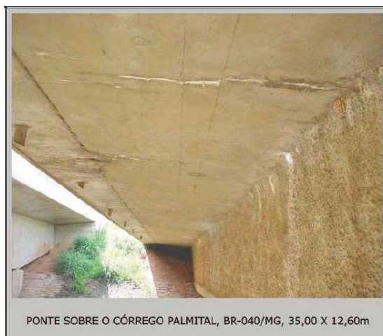
Figura 10 -Face inferior da laje superior: Infiltração e eflorescência Fonte: DNIT (2010)
