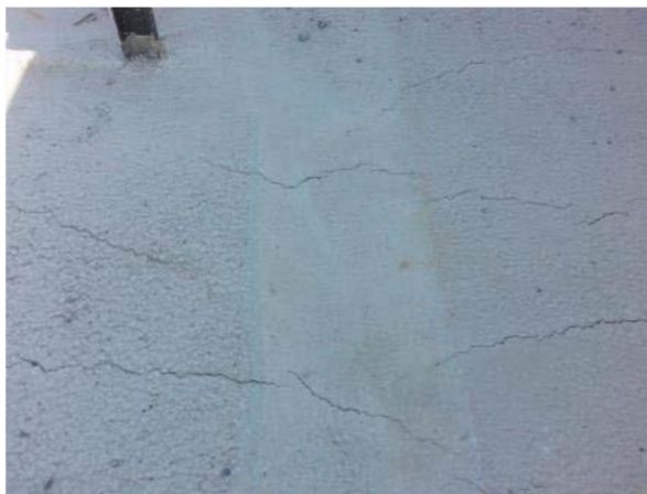
Figura 4 –Fissuras devido a retração na argamassa Fonte: Granato e Polidoro, 2013.
