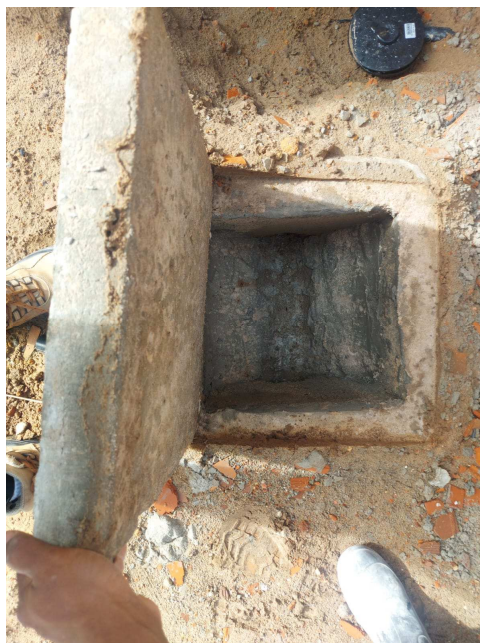
Figura 41 – Caixa de passagem.
