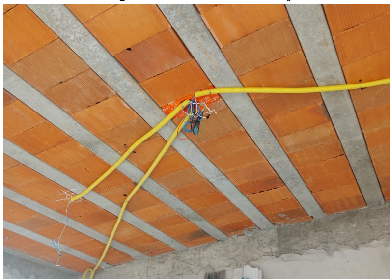
Figura 26 – Ponto de iluminação.
