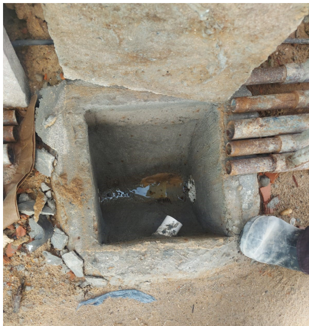
Figura 39 – Caixa de Inspeção.
