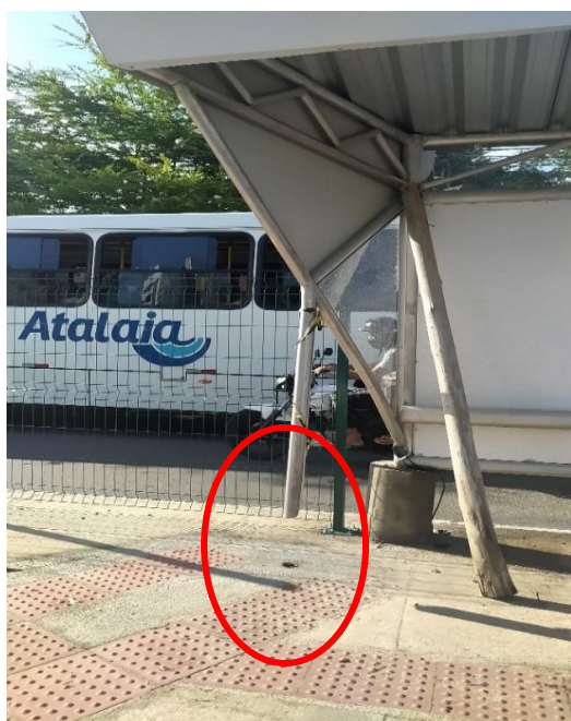
Figura 55 – Ponto com Escora Improvisada e Ausência de Estrutura Essencial
