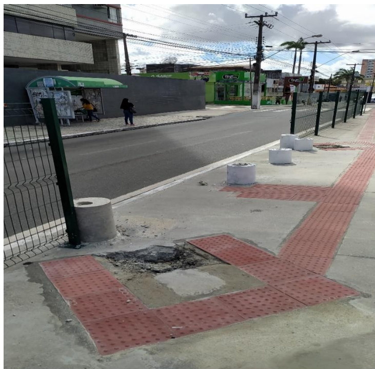
Figura 57 – Ponto Arrancado com Impacto de um Veículo Envolvido em Acidente
