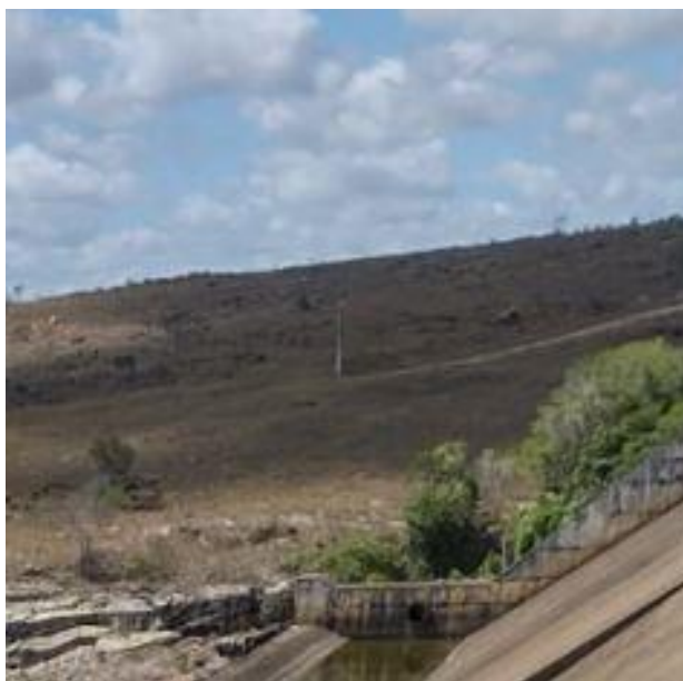
Foto 33 - Descarga de fundo com despejo no leito da bacia de dissipação, contudo não está funcional.
