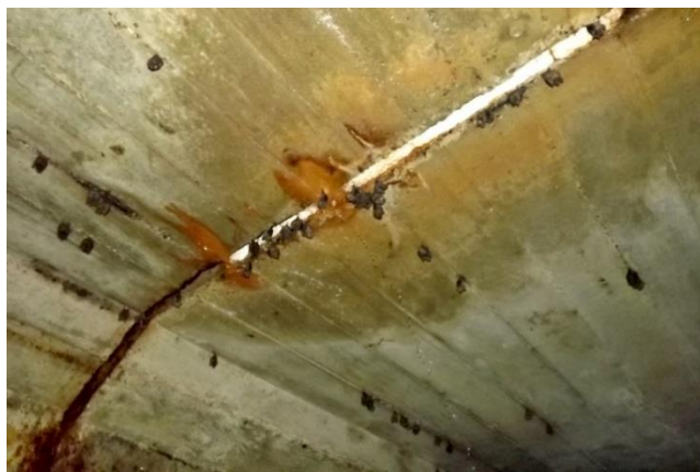
Figura 16 - Infiltrações na Galeria da Barragem Jacarecica II em Malhador/SE.
