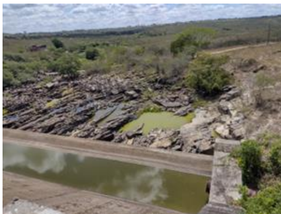
Foto 30 - Parte do sistema de enrocamento já erodido devido a abrasão da água.
