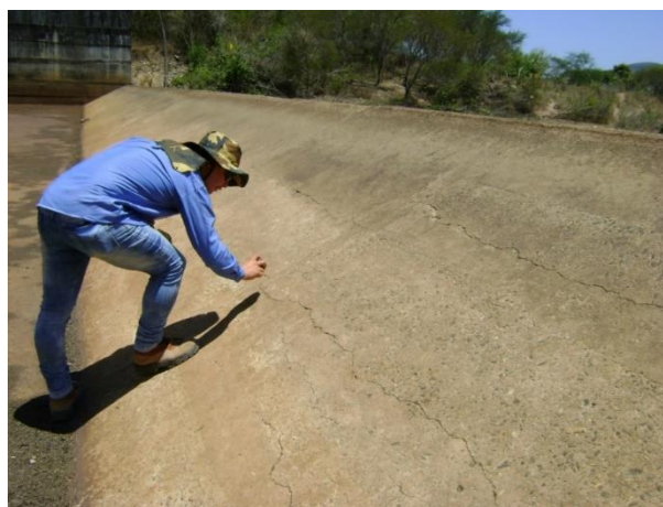
Foto 7 - Fissuras na Bacia de Dissipação da Barragem Jacarecica I em Itabaiana/SE.
