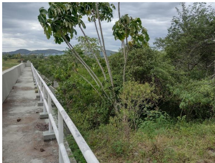
Foto 15 - Paramento de jusante direito do barramento, com presença de vegetação arbustiva e arbórea (tronco - \varnothing \leq 0,5 m).
