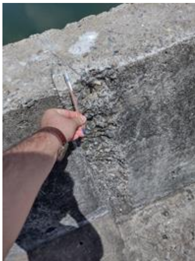
Foto 25 - Seção de concreto desagregada (bicheira) - localizada sobre a crista direita do barramento.
