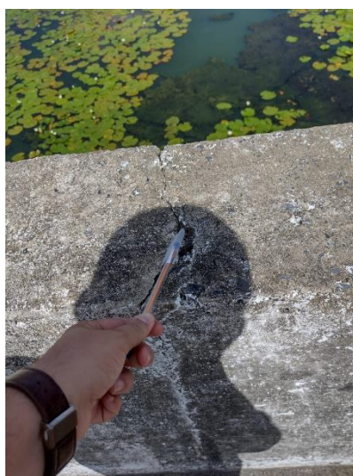
Foto 26 - Junta de dilatação deficiente com fissura, localizada sobre a crista esquerda do barramento.
