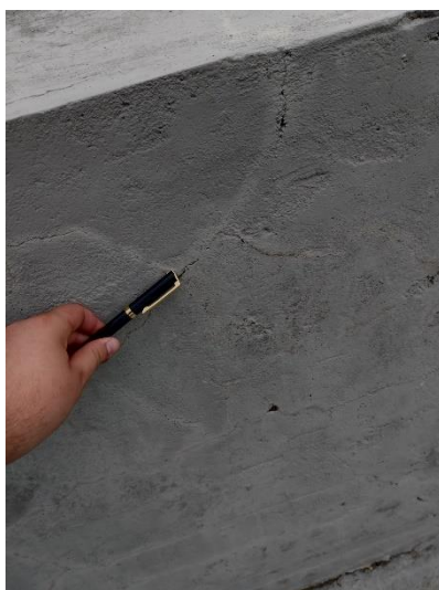
Foto 13 - Fissura localizada sobre a ombreira direita do barramento.
