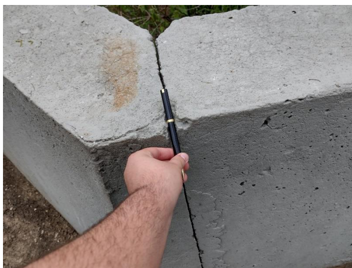
Foto 14 - Junta de dilatação deficiente localizada sobre a ombreira direita do barramento.
