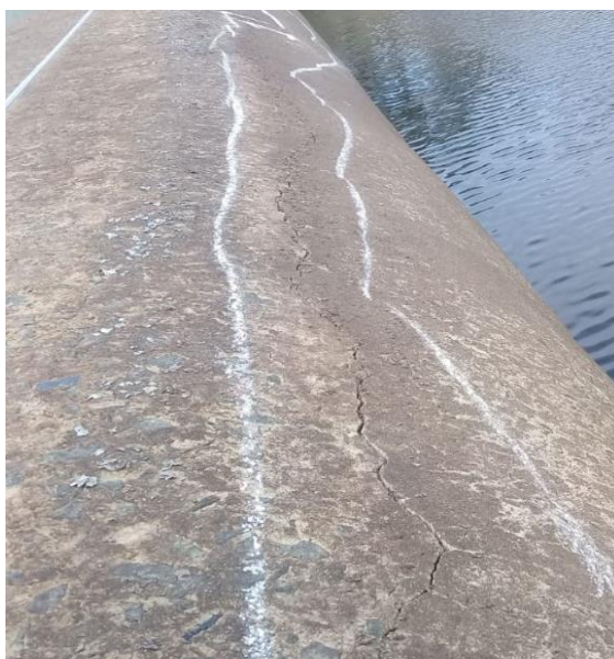
Figura 18 - Cavitação no Vertedouro da Barragem Jacarecica I Em Itabaiana/SE.
