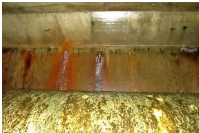
Figura 17 - Surgências na Galeria da Barragem Jacarecica II em Malhador/SE.
