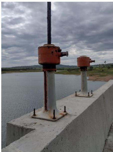
Foto 18 - Registro de tomada d'água com pontos de corrosão, porém funcional.
