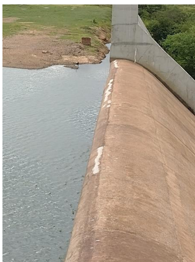
Foto 17 - Vertedouro de superfície com pontos de recuperação devido aos desgastes superficiais e pontos de cavitação.
