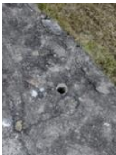
Foto 34 - Passeio de acesso sobre a ombreira direita do maciço, onde é visível o sistema de drenagem comprometido.
