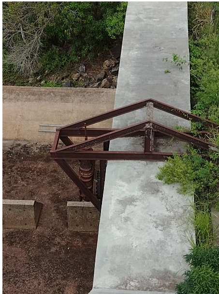
Foto 19 - Descarga de fundo com despejo no leito da bacia de dissipação, com pontos de oxidação.
