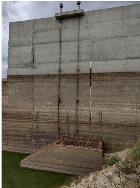
Foto 20 - Tomada d'água com sistema de acionamento de comporta através de hastes de aço e tecnologia de gradil.
