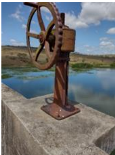
Foto 32 - Registro de tomada d'água com déficits de vedação devido a corrosão.
