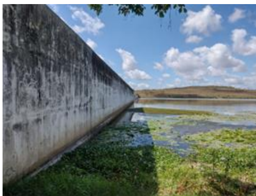
Foto 37 - Eutrofização de material no reservatório d'água a esquerda do vertedouro.
