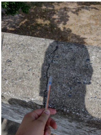
Foto 23 - Fissura localizada sobre a ombreira esquerda do barramento.
