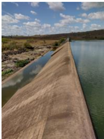
Foto 31 - Vertedouro de superfície com desgastes superficiais tais como fissuras e pontos de cavitação.
