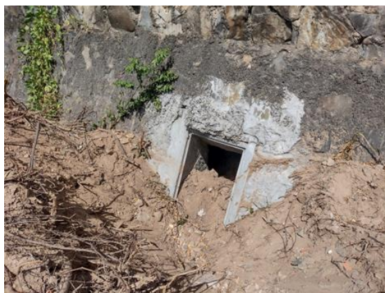
Foto 35 - Porta de acesso a galeria internas localizada na ombreira esquerda do talude, com sua utilização comprometida devido à dificuldade de acesso.
