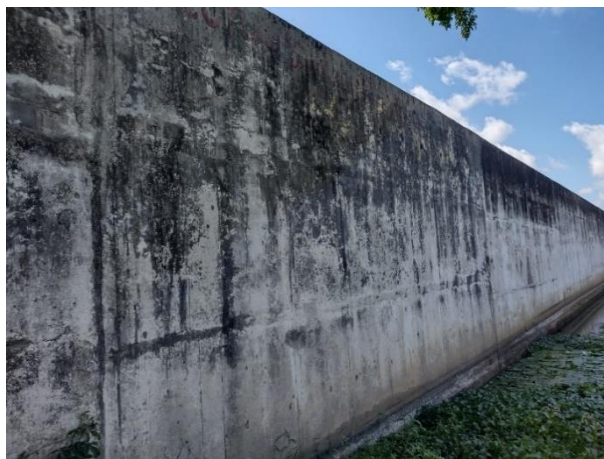
Foto 24 - Fissura localizada sobre o talude de montante do barramento.
