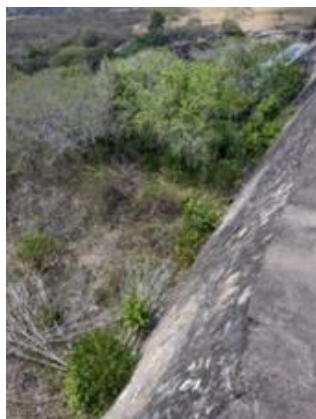
Foto 29 - Paramento de jusante esquerdo do barramento, com de vegetação arbustiva e arbórea (tronco - \varnothing \geq 0,5 m).
