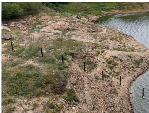
Foto 22 - Assoreamento de material granular no reservatório d'água a direita do vertedouro.
