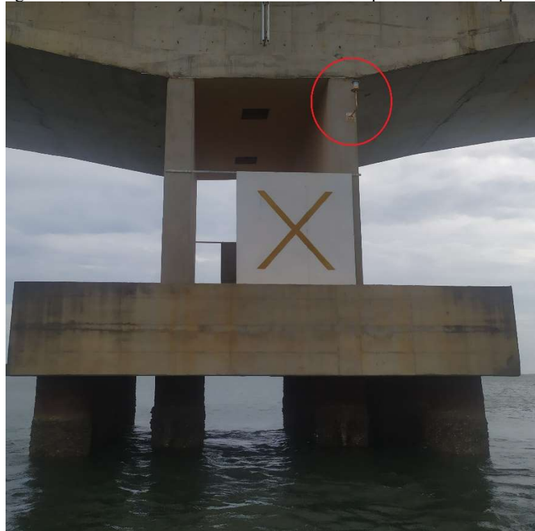
Figura 64- Lanterna de emissão de Luz amarela e painel de sinal especial.
