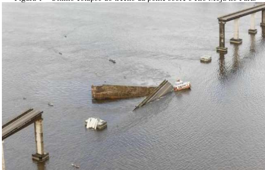
Figura 1 – Último colapso do trecho da ponte sobre o Rio Moju no Pará.
