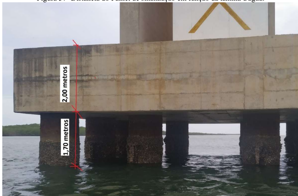
Figura 57- Distância do Painel de sinalização em função da lâmina d'água.
