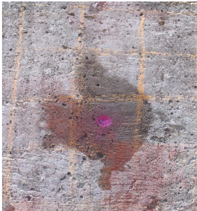
Figura 17 – Mudança de cor na estrutura após o uso da fenolftaleína Fonte: Autor, 2021
