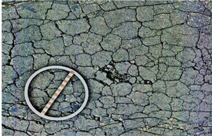
Figura 4 - Trinca tipo “couro de jacaré”.
