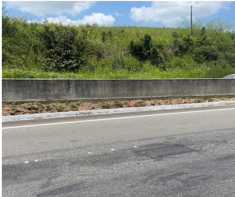
Foto 25 - Meio-fio caído no km 42 (sentido decrescente).
