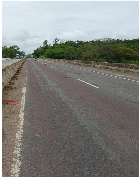
Foto 35 - Sinalização horizontal desgastada no km 83 (sentido crescente).
