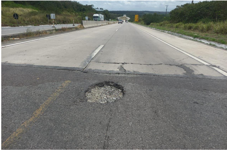
Foto 6 - Defeitos no pavimento do km 26 (sentido crescente).
