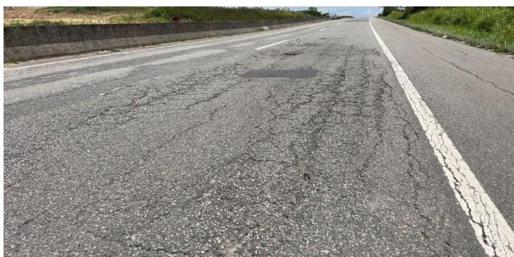
Foto 11 - Defeitos no km 83 (sentido decrescente).
