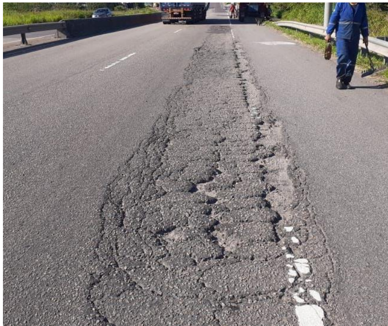
Foto 21 - Trincas do tipo “couro de jacaré” no km 85 (sentido decrescente).
