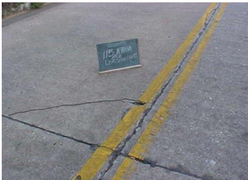
Figura 15 - Fissura de canto.
