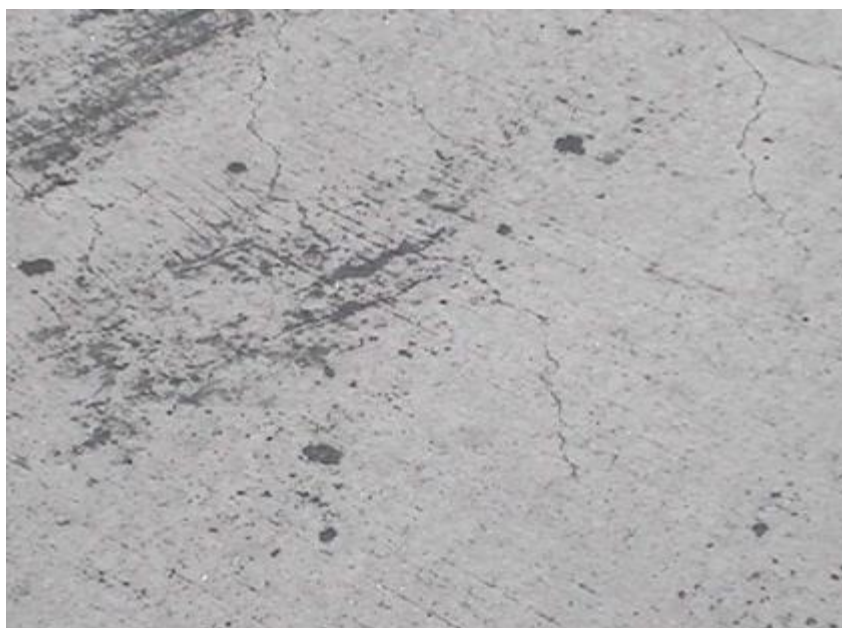
Figura 26 - Fissuras de retração plástica.
