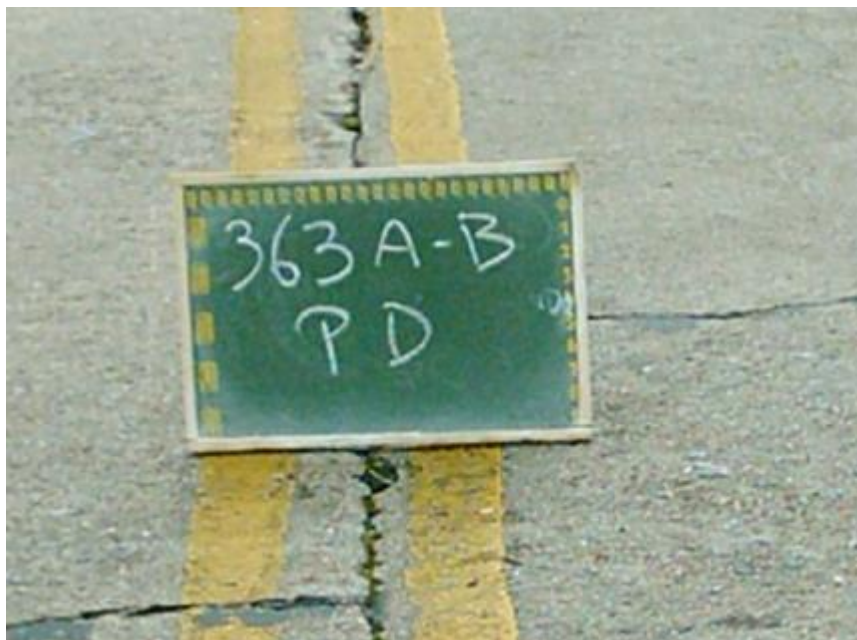
Figura 17 - Falha na selagem das juntas.
