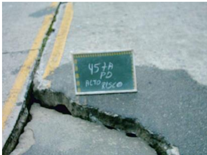
Figura 27 - Esborcinamento ou quebra de canto.
