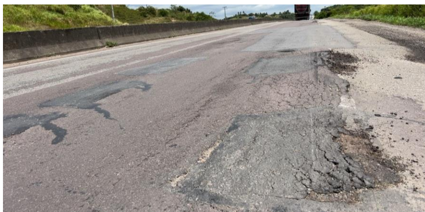
Foto 10 - Defeitos no km 82 (sentido decrescente).
