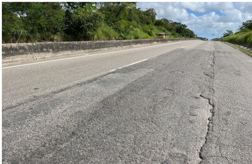
Foto 34 - Pavimento do km 86 (sentido decrescente).
