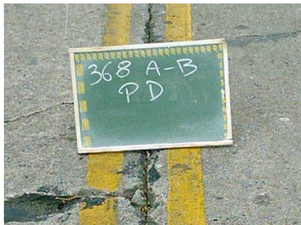
Figura 28 - Esborcinamento de juntas.
