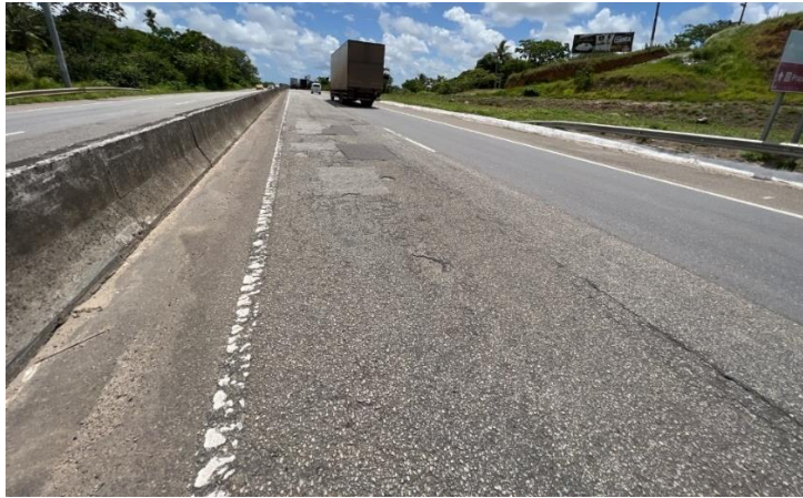
Foto 33 - Situação do km 81 (sentido decrescente).
