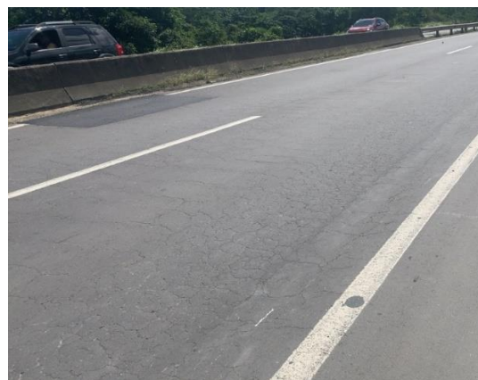
Foto 9 - Trincas do tipo “couro de jacaré” no km 85 (sentido decrescente).
