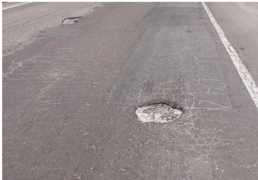
Foto 19 - Panelas no km 87 (sentido decrescente).
