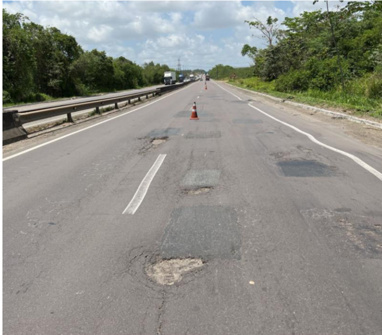
Foto 12 - Defeitos no km 84 (sentido crescente).
