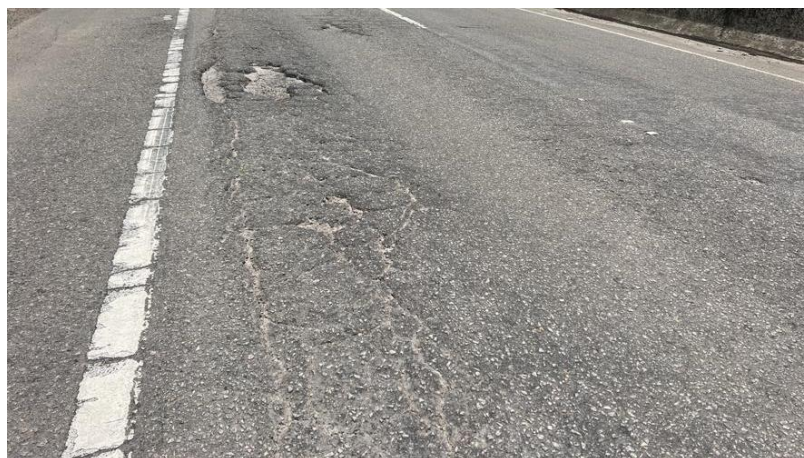
Foto 32 - Estado do pavimento no km 79 (sentido decrescente).
