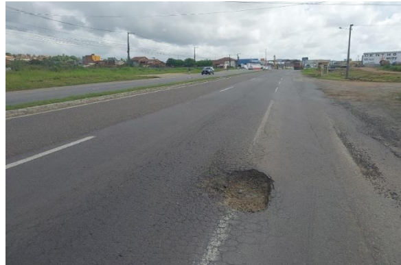
Foto 28 - Painela no km 93 (sentido decrescente).
