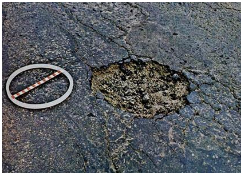
Figura 13 - Panela ou buraco.
