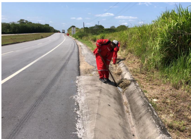
Foto 13 - Limpeza e estado da caiação da sarjeta no km 12 (sentido decrescente).
