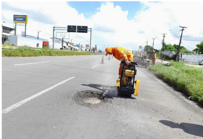
Foto 1 - Panela na BR-101/SE.
