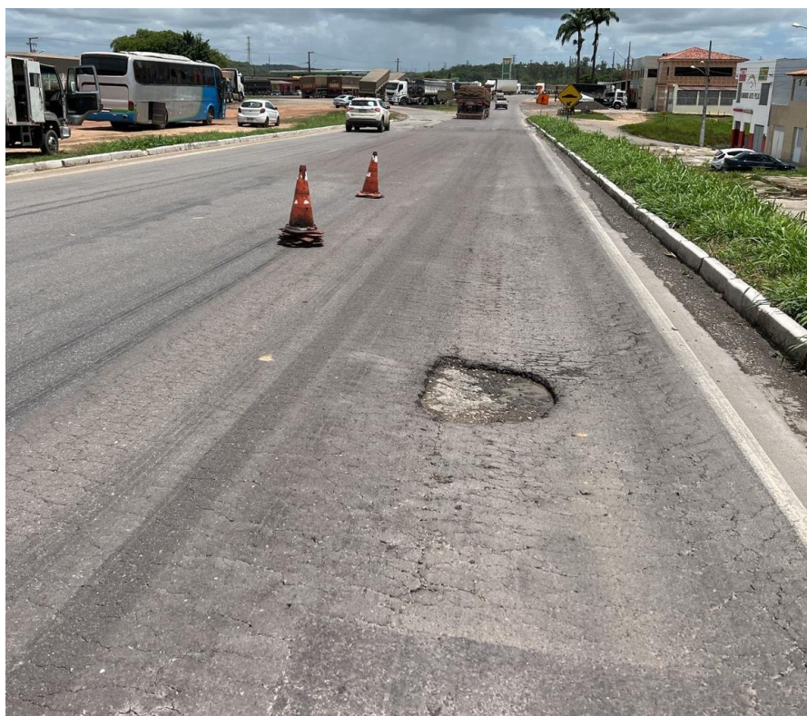
Foto 30 - Panela no km 78 (sentido decrescente).
