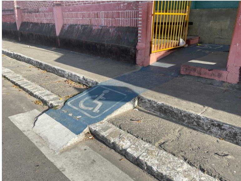
Figura 16 - Rampa da rua em frente à escola
