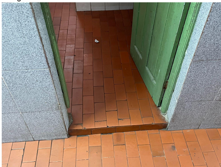
Figura 24 - Desnível no acesso ao banheiro do bloco infantil
