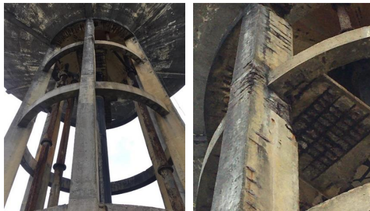
Figura 20 - Vista das manifestações patológicas em pilares Fonte: Autor (2021)
