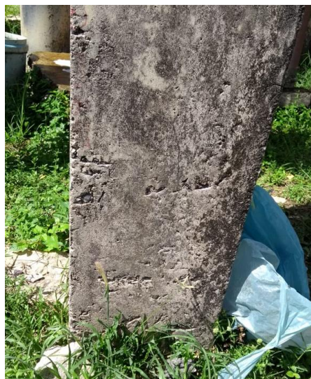
Figura 28 - Pilar 02 com o concreto segregado Fonte: Autor (2021)
