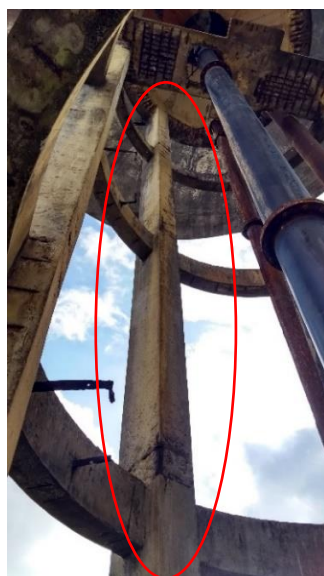
Figura 35 - Exposição de armadura no pilar 03 Fonte: Autor (2021)
