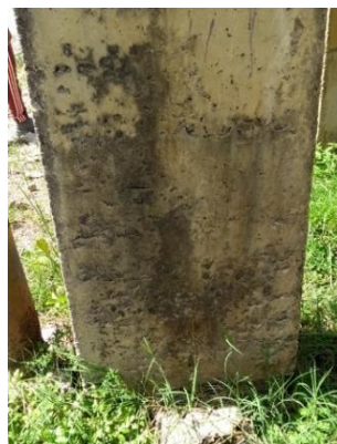
Figura 19 - Segregação no pilar 01
