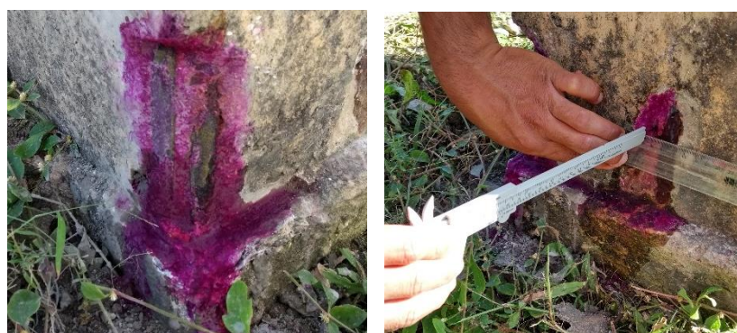
Figura 38 - Ensaio de carbonatação no pilar 06 Fonte: Autor (2021)
