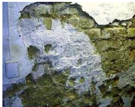
Figura 6 - Efeito de subflorescência Fonte: Freitas (2018)
