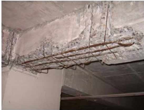
Figura 8 - Desagregação do concreto em viga Fonte: Araldi (2013)
