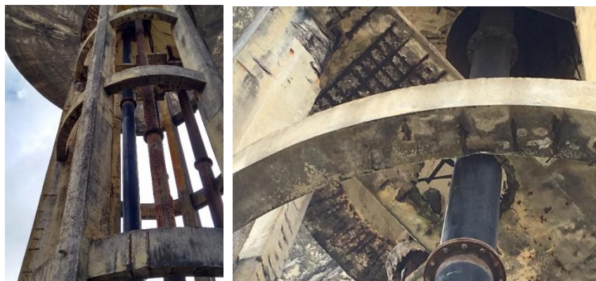
Figura 25 - Presença de manifestações patológicas nas cintas do reservatório Fonte: Autor (2021)
