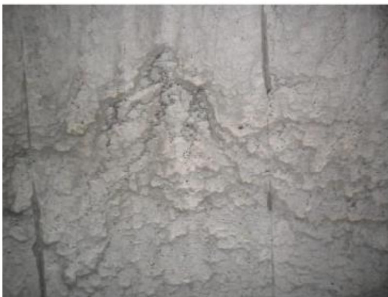
Figura 6 - Superfície mal-acabada da parede de concreto
