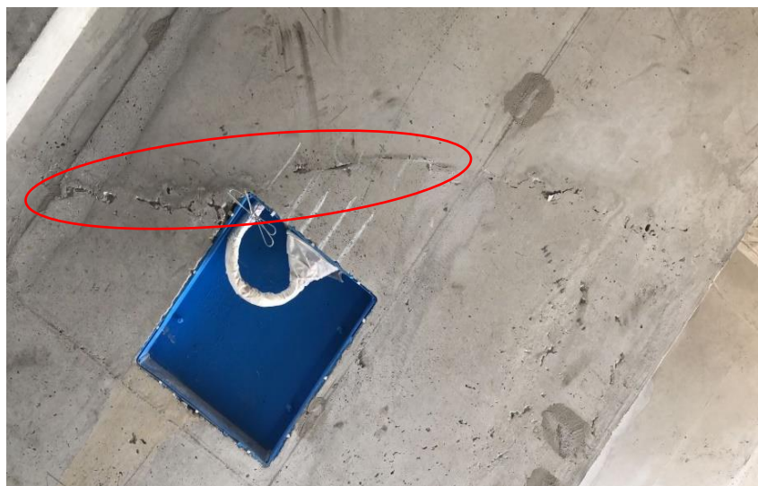
Figura 18 - Segregação “B” metros do piso entre 1,20 e 2,00
