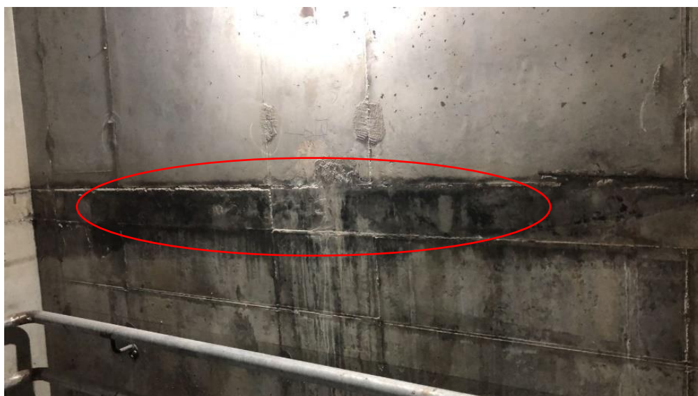
Figura 22 - Defeito geométrico causado pela abertura entre placas
