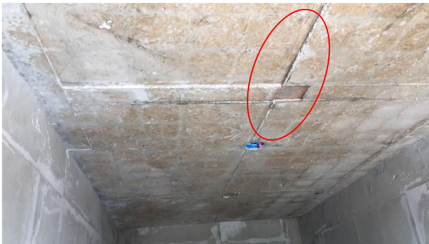
Figura 19 - Segregação “C” acima de 2,00 metros do piso
