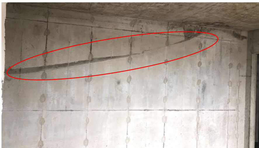
Figura 21 – Junta fria observada em uma das paredes
