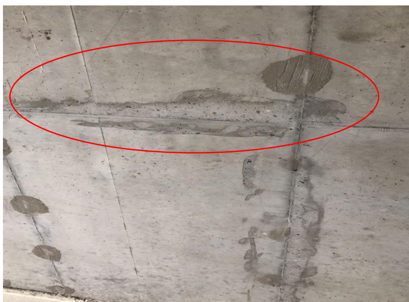
Figura 16 - Segregação no entorno da junta entre fôrmas.
