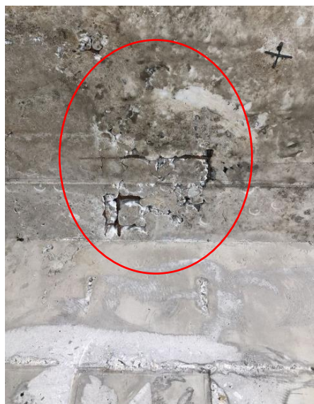
Figura 20 - Armadura exposta na superfície do concreto
