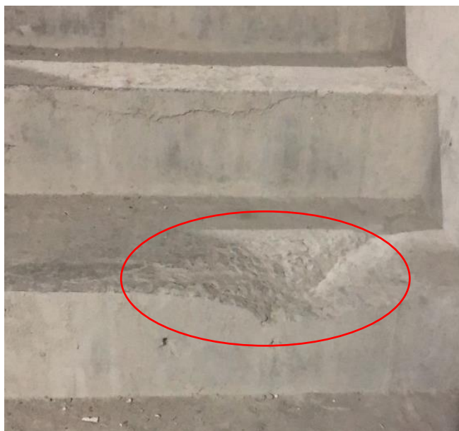
Figura 23 - Defeito geométrico causado por defeito nas placas
