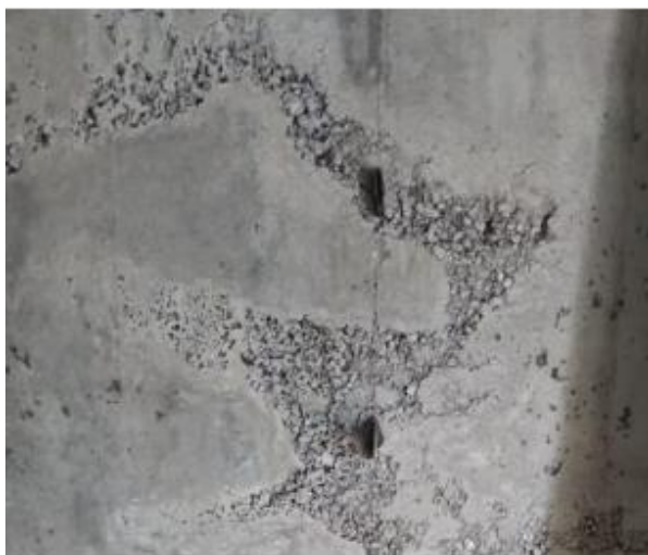
Figura 7 - Segregação do concreto na parede de concreto
