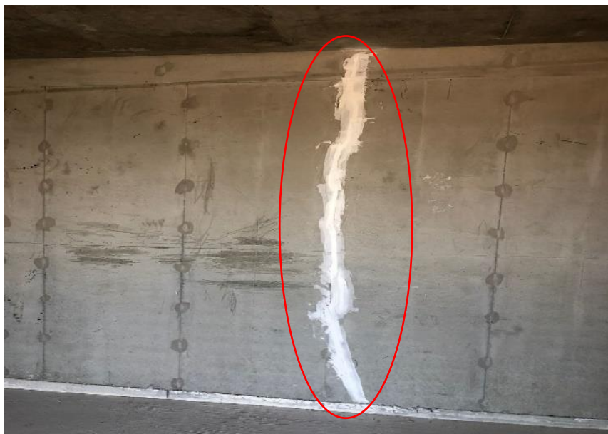
Figura 14 - Fissura formando ângulo de 90°
