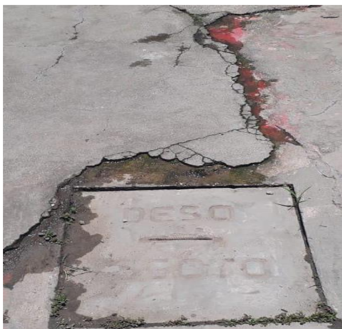
Figura 7 - Extravasamento na caixa de passagem de uma residência na Rua José Pacheco no Conjunto Juscelino Kubitschek.
