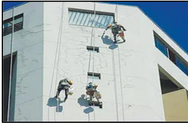
Figura 7 – Fissura mapeada causada por retração de secagem da argamassa
