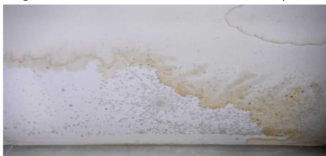
Figura 31 – Bolor e manchas de umidade na parede
