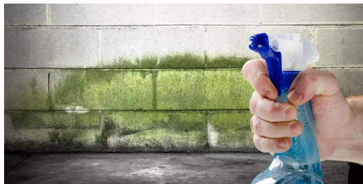
Figura 33 – Limo em parede
