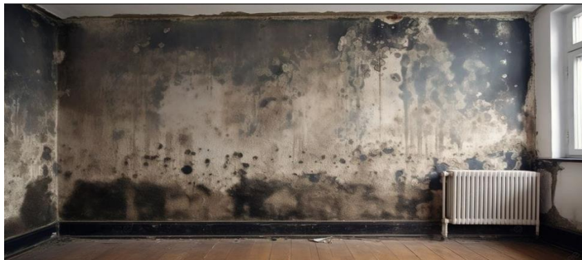
Figura 32 – Mofo e sujeira na parede
