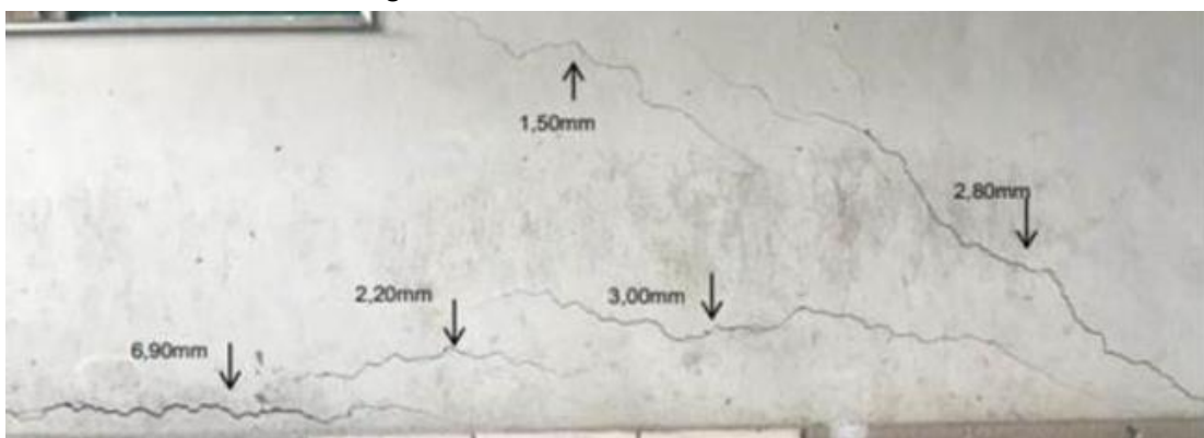
Figura 21 – Trinca, rachadura e fenda
