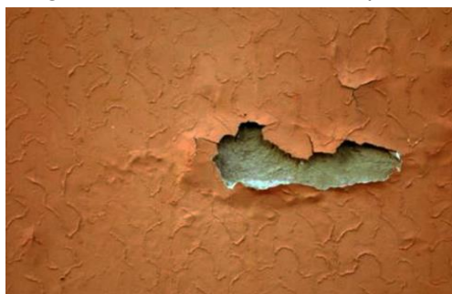
Figura 24 – Descascamento de pintura
