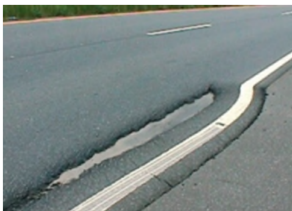
Figura 06 – Escorregamento do pavimento asfáltico
