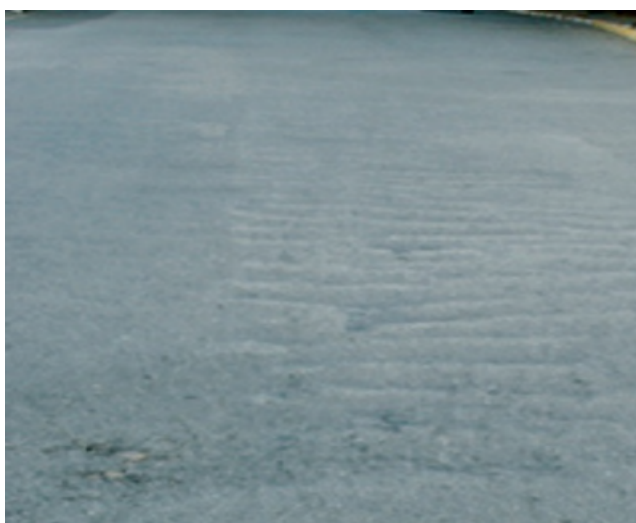
Figura 03 – Corrugação do pavimento asfáltico
