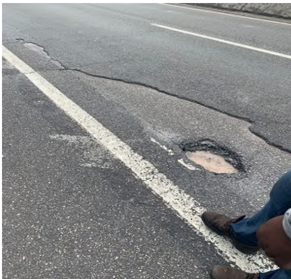
Foto 03 – Panela (buraco) no pavimento asfáltico
