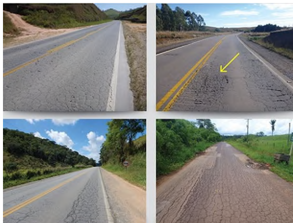
Figura 07 – Fendas diversas no pavimento asfáltico
