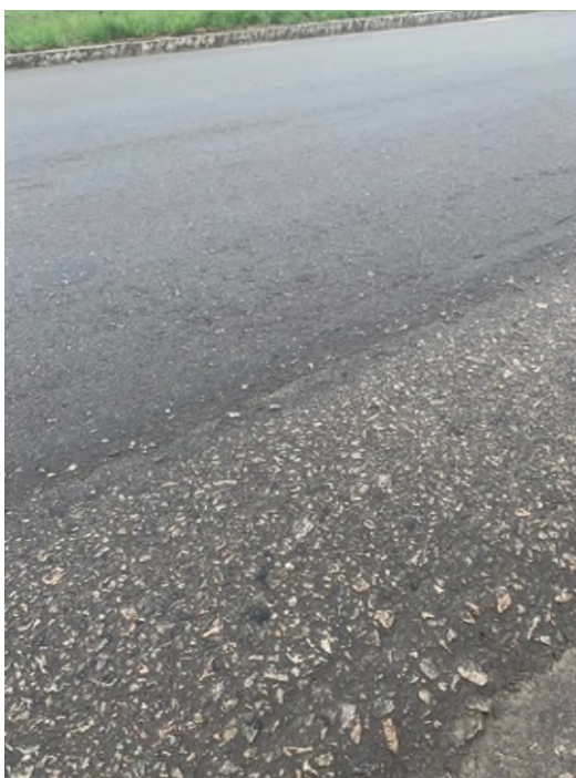
Foto 14 – Trecho KM 91,5 com leve exposição de agregados e ondulações
