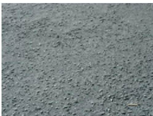
Figura 05 – Desgaste do pavimento asfáltico
