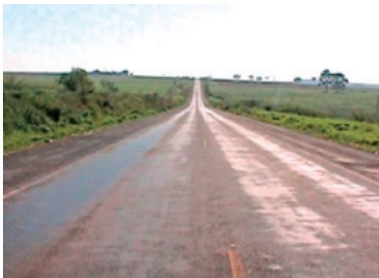
Figura 04 – Exsudação do pavimento asfáltico
