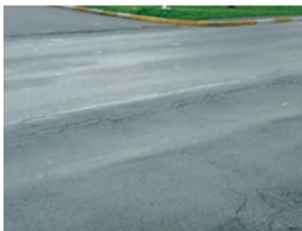
Figura 02 – Afundamento do pavimento asfáltico
