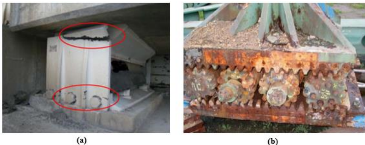
Figura 19 – (a) Fissuração do aparelho de apoio, (b) Problemas de corrosão do aparelho metálico
