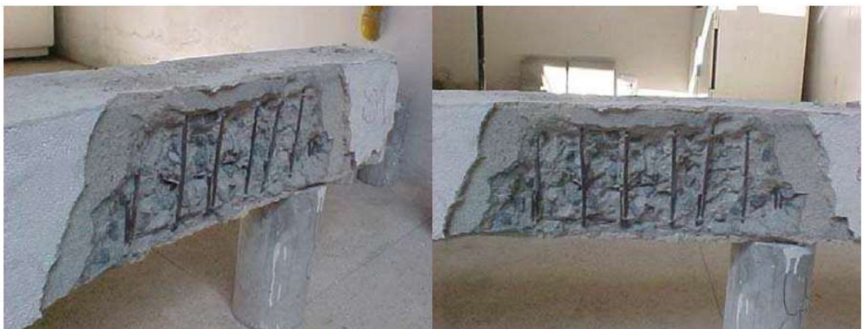
Figura 13: Spalling em viga de concreto armado.
