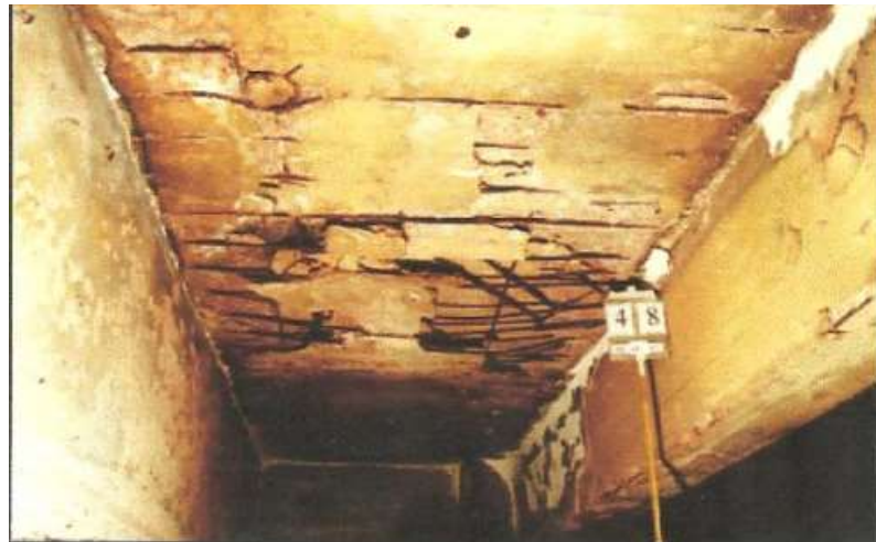
Figura 12: Spalling em estrutura de concreto armado.
