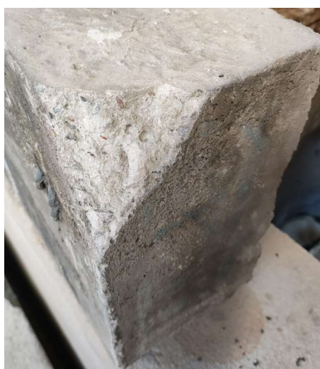
Figura 50: Spalling (Grupo II).
