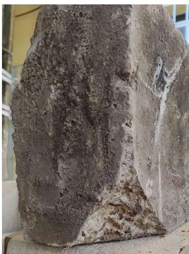
Figura 49: Spalling (Grupo I).
