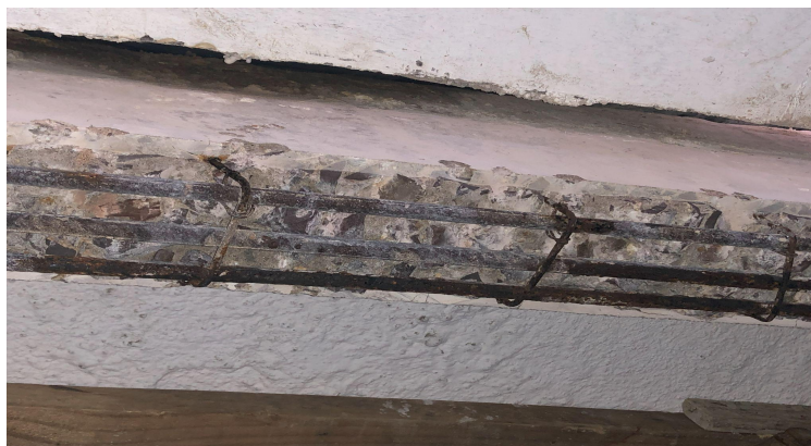
Foto 23: Armaduras da viga V1 expostas.
