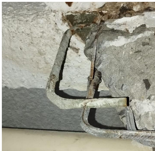
Foto 16: Identificação de processo corrosivo na extremidade do console C5.
