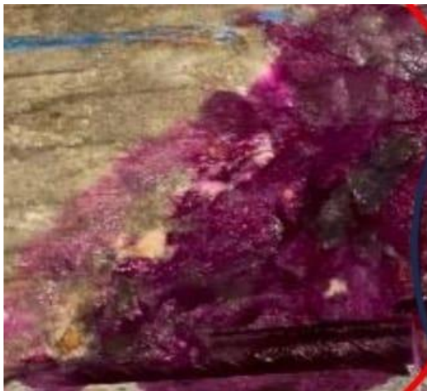
Foto 5: Console C5 após aspersão de fenolftaleína.
