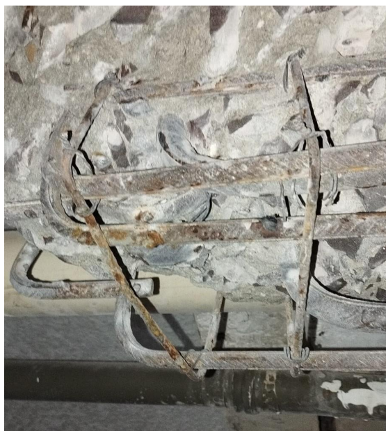
Foto 15: Identificação de processo de corrosão nas armaduras do console C5.
