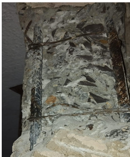
Foto 32: Estribos do pilar P3 comprometidos.
