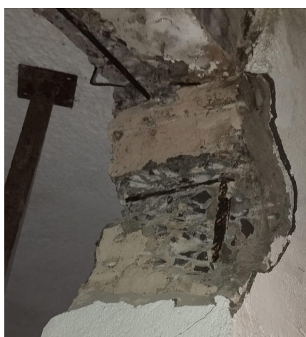
Foto 29: Pilar P3 antes da recuperação.
