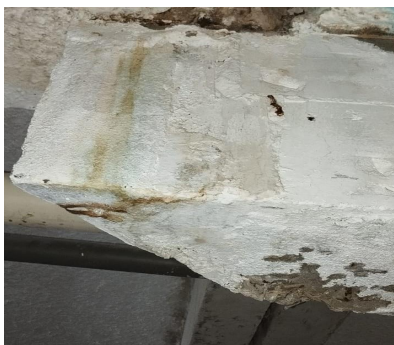
Foto 13: Console C5 antes da recuperação.
