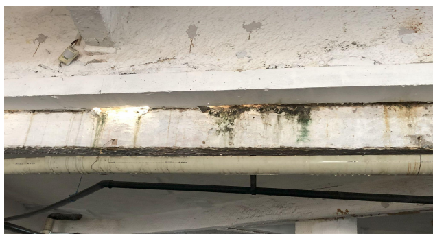
Foto 21: V1 antes da recuperação.
