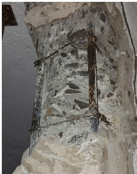
Foto 31: Armadura comprometida do pilar P3.
