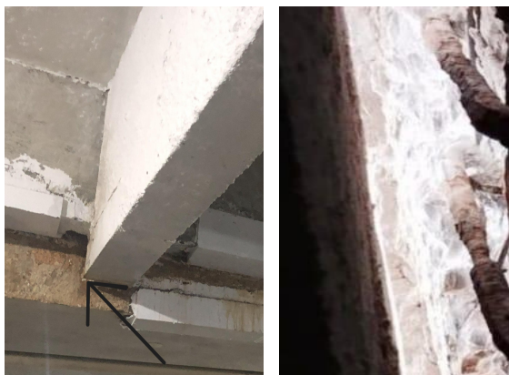
Foto 36 e 37: Viga de sustentação da piscina suspensa com armadura exposta em sua cabeceira.
