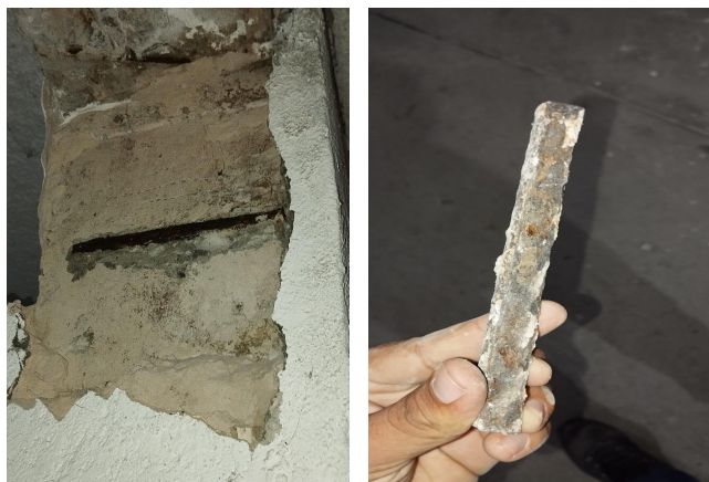
Foto 27 e 28: Peça de aço exposta dentro do pilar P3.
