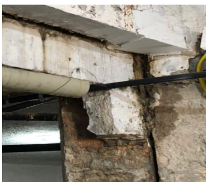
Foto 6: Console C1 antes da recuperação.
