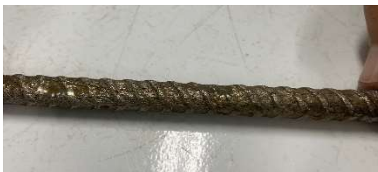
Figura 19 - Corrosão por pites nas barras
