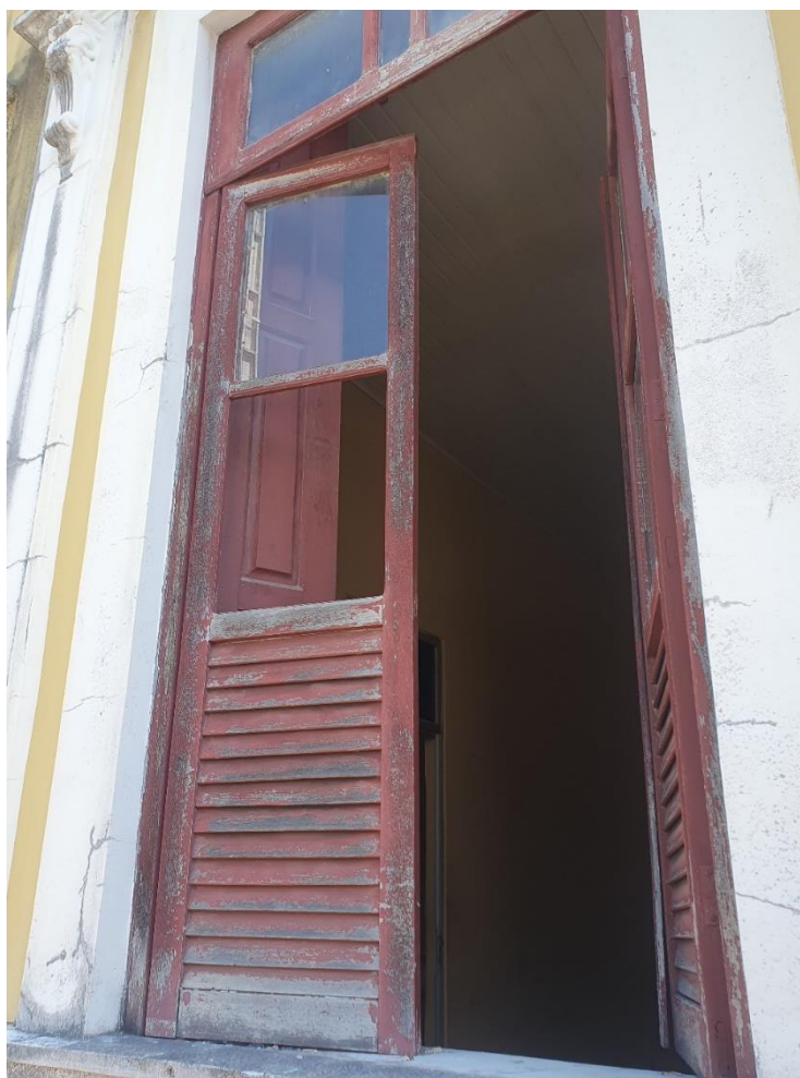
Foto 23 - Falta de vidros e mau estado da pintura
