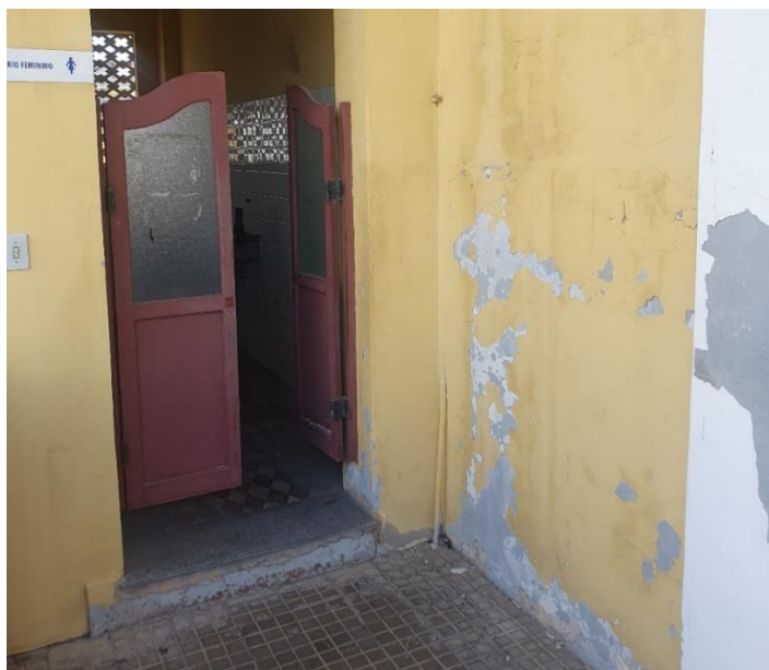
Foto 16 - Parede com revestimento danificado
