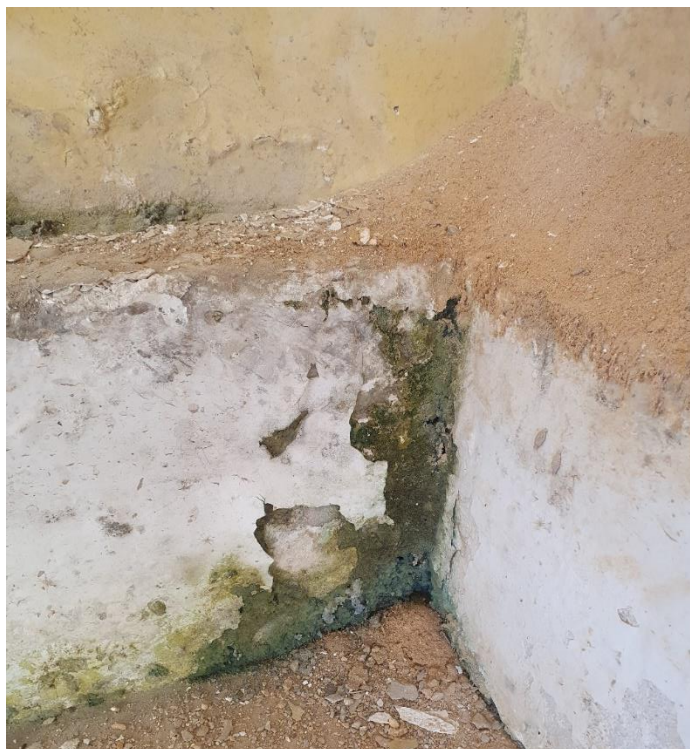
Foto 11 - Manchas nas paredes
