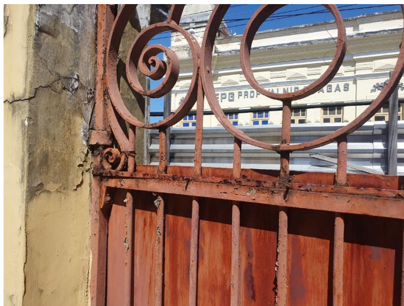
Foto 25 - Presença de ferrugem no portão
