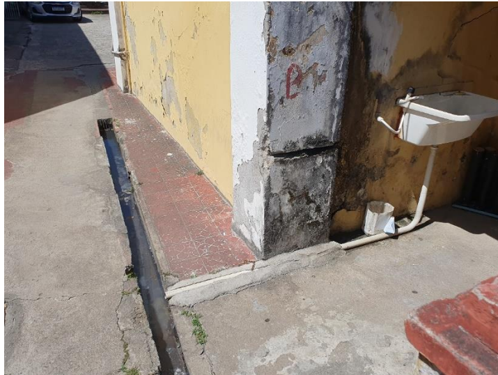
Foto 4 - Tubulação exposta e empoçamento
