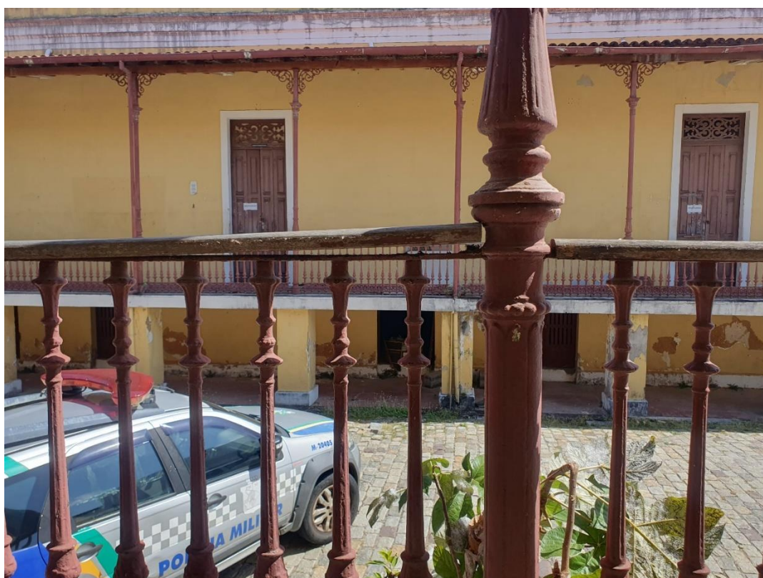
Foto 20 - Deslocamento da madeira do guarda-corpo
