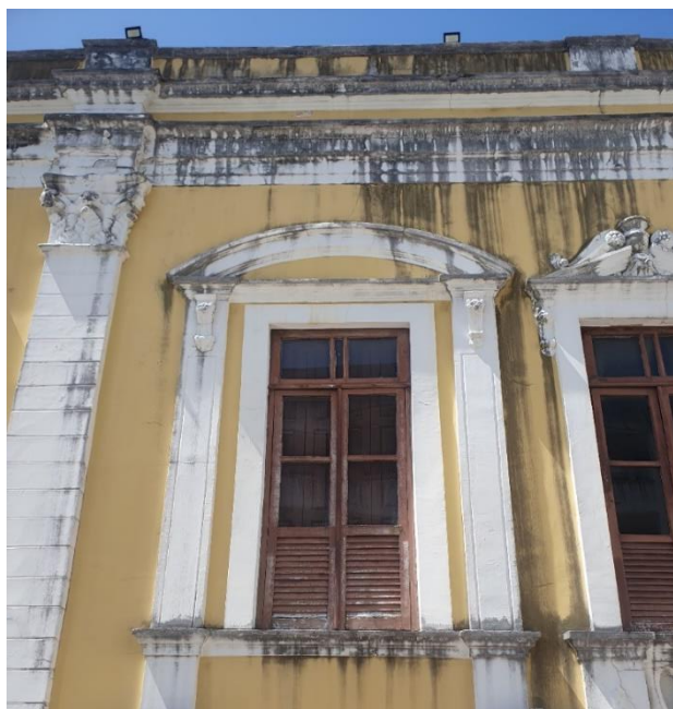
Foto 5 - Manchas de escorrimento
