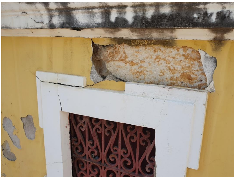
Foto 9 - Descontinuidade na parede
