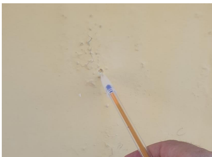
Foto 17 - Bolhas no revestimento
