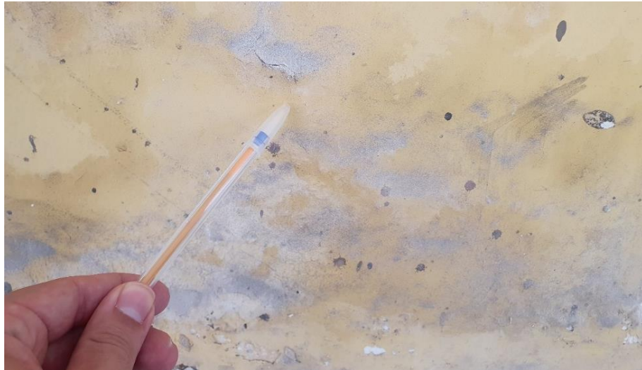
Foto 14 - Manchas provenientes de umidade
