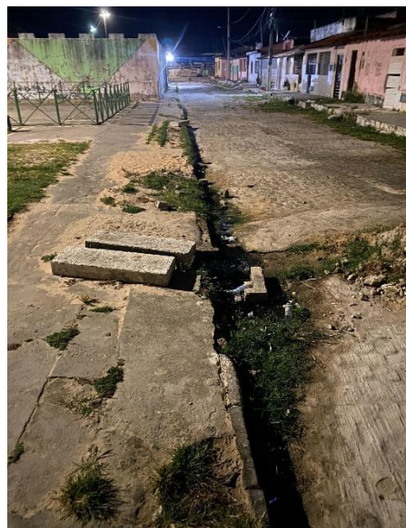
Figura 12. Esgoto escorrendo nas ruas de Pirambu/SE. Autor(a): Roberta Muniz, 2023.
