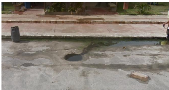
Figura 15 – Extravasamento de rede de esgotamento sanitário em região costeira de Aracaju.
