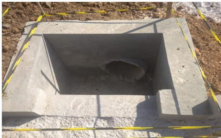
Figura 05: Boca de lobo para rede de drenagem
