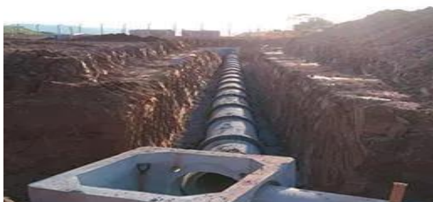
Figura 7 - Poço de Visita
