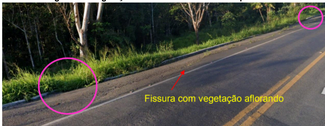
Figura 16 - Vegetação aflorando nas fissuras do pavimento
