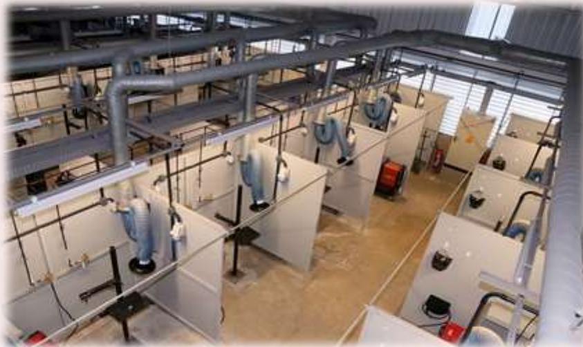
Fig. 2 - Laboratório de Soldagem
