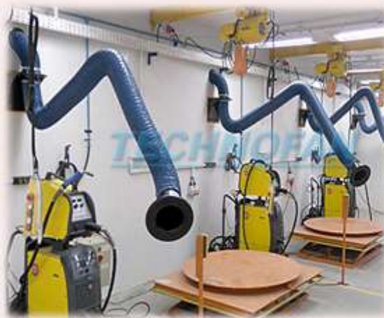
Figura 9 - Sistema de exaustão forçada
