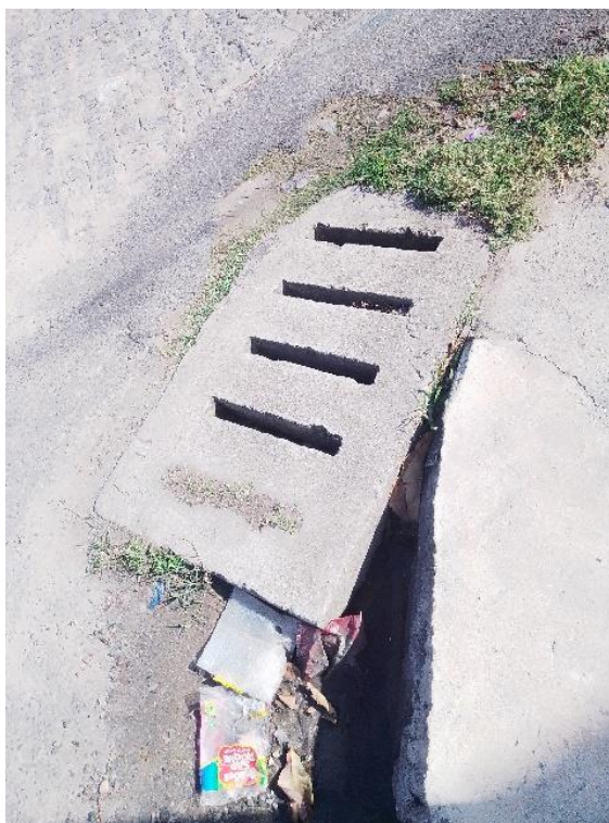
Figura 13 - Boca de lobo com presença de resíduos sólidos (lixo)
