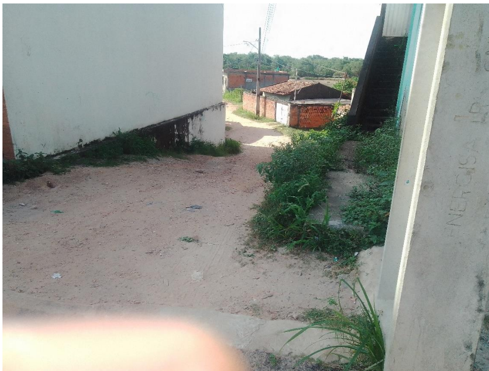
Figura 19 - Acesso da Av. Sergipe do Norte sem pavimentação
