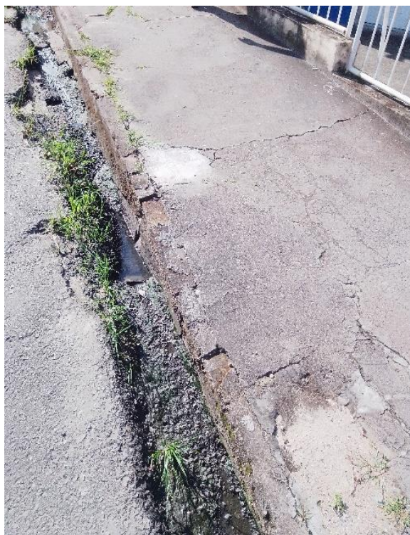
Figura 14 - Valeta entre o meio fio e o pavimento
