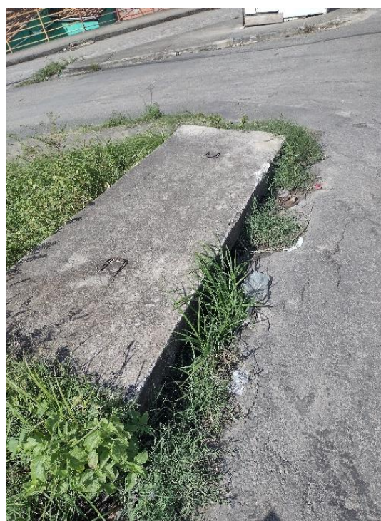
Figura 12 - Boca de lobo com presença de vegetação
