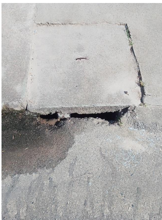
Figura 11 - Boca de lobo com abertura reduzida devido a pavimentação
