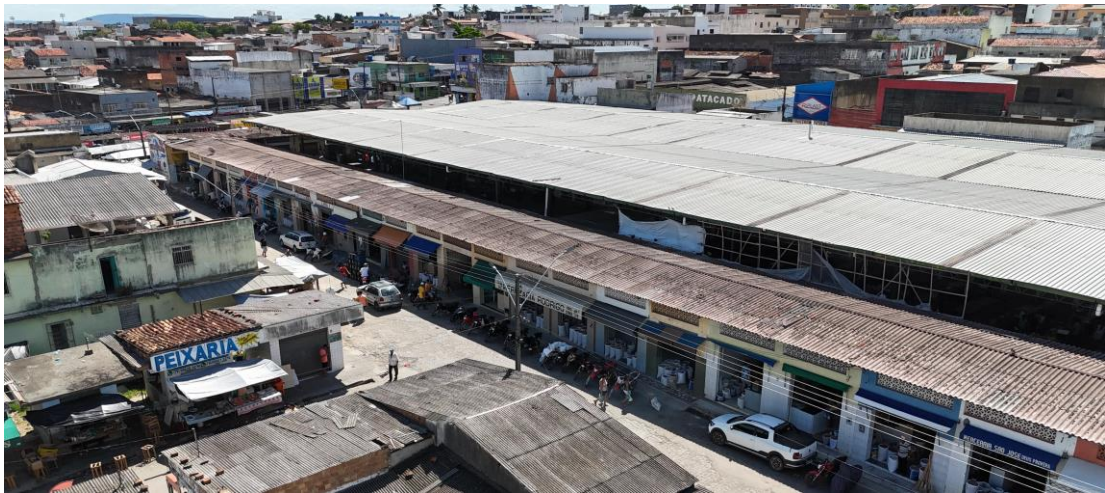
Figura 14 – Falhas da cobertura do Mercado Rosendo Ribeiro.
