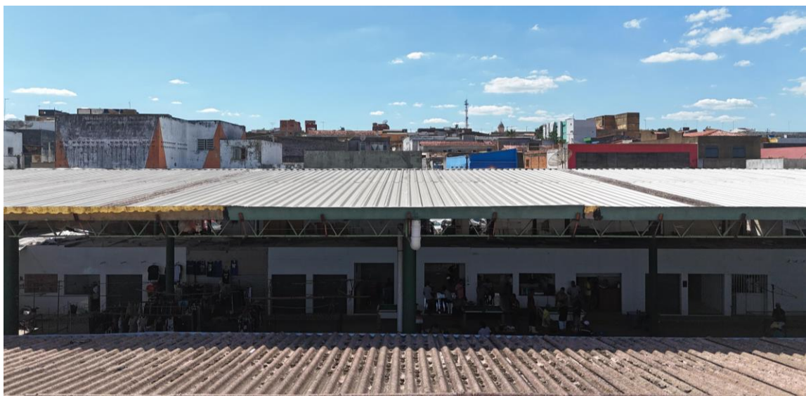
Figura 15 – Falhas da cobertura do Mercado Rosendo Ribeiro.
