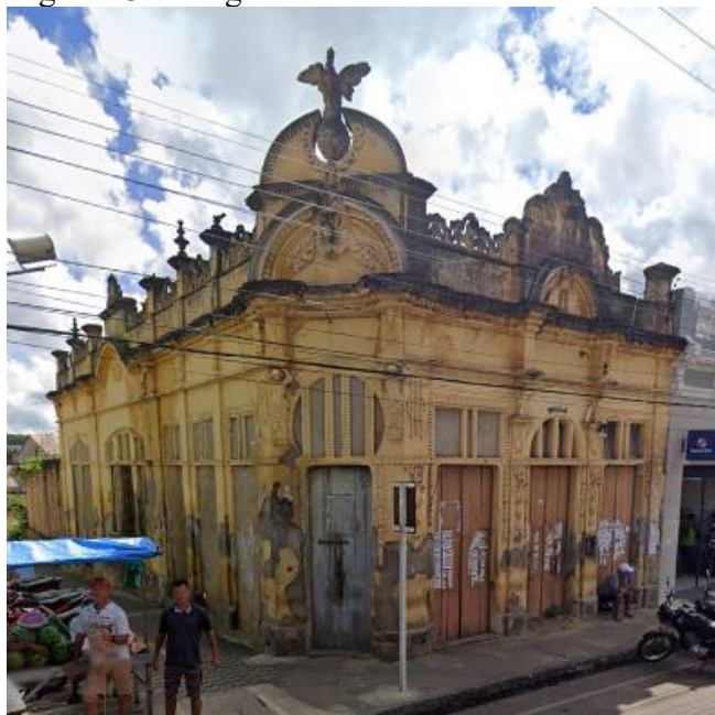
Figura 13 - Imagem do Prédio deteriorado.
