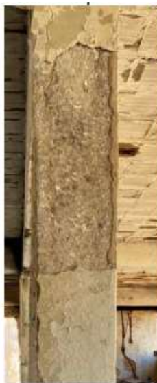
Figura 12 – Destacamento do concreto em pilar.
