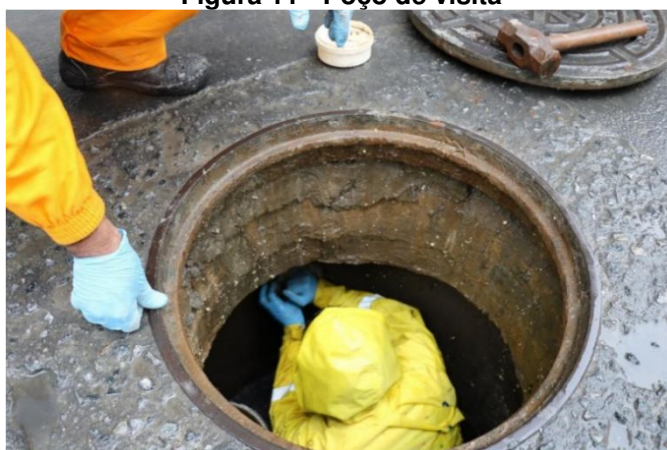
Figura 11 - Poço de visita
