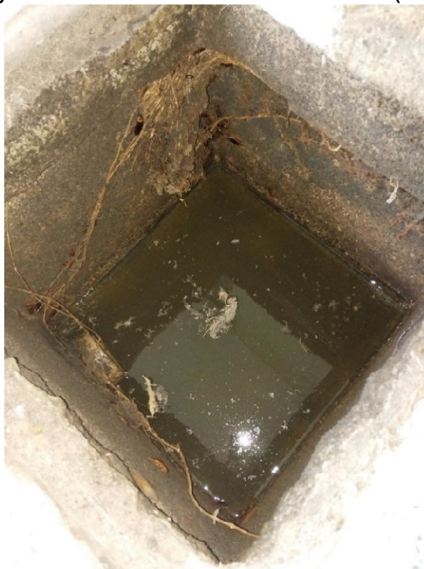
Fotografia 12 - Caixa 04 do corredor do bloco VII (Química)
