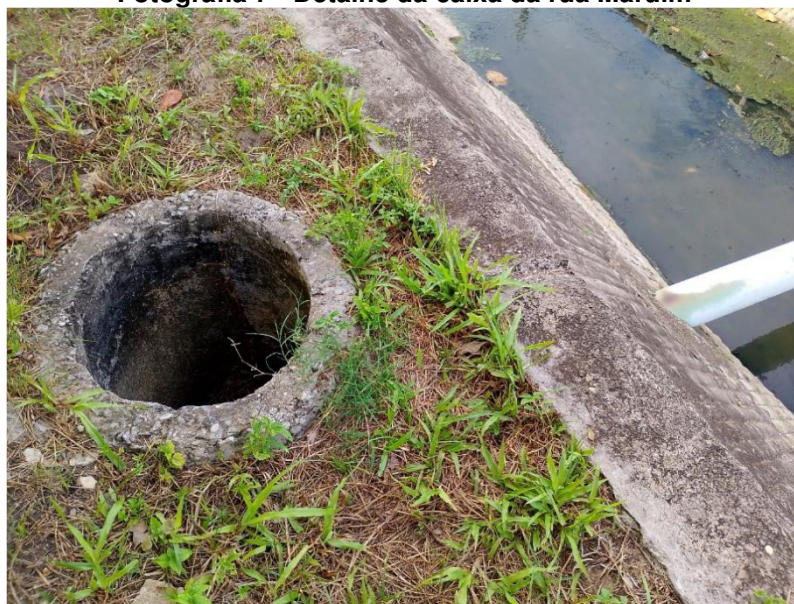
Fotografia 7 - Detalhe da caixa da rua Maruim
