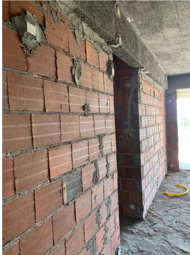
Figura 17 — Lado da parede com aresta saliente da viga
