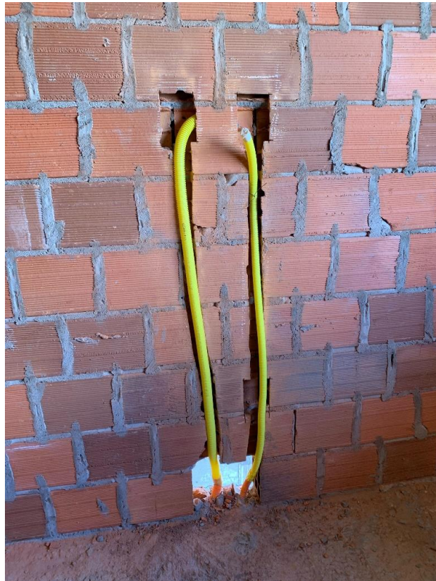
Figura 47 — Subida na alvenaria de tubulação elétrica que passa pela laje do piso
