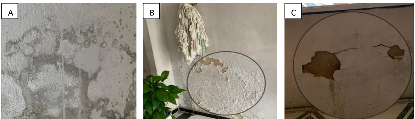
Figura 13 - Alvenaria da Garagem: A) Eflorescência, B) Deterioração da pintura, C) Descascamento do reboco
