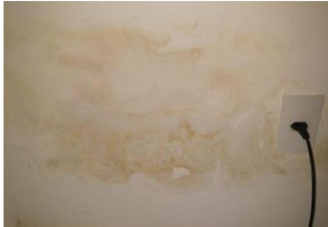
Figura 2 - Manchas na parede de uma edificação
