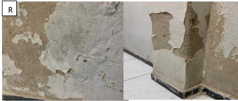
Figura 21 - Alvenaria do Quarto 2: Q) Descascamento do reboco, R) Descascamento do pintura
