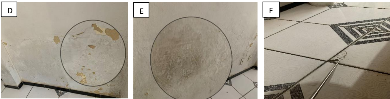
Figura 14 - Alvenaria da Sala: D) Deterioração da pintura, e descascamento do reboco, E) manchas, F) fratura da peça cerâmica
