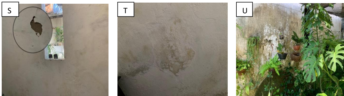
Figura 22 - Alvenaria do Quarto 3: S) Descascamento, T) Manchas , U) Mofo
