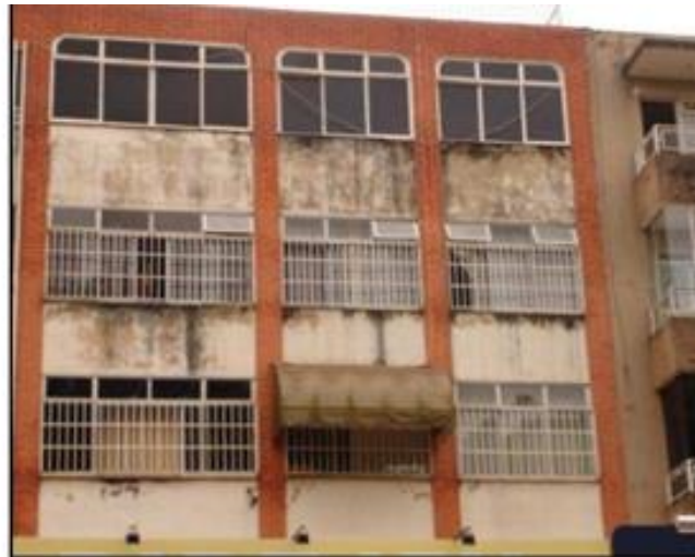
Figura 1 - Bolor na fachada de uma edificação
