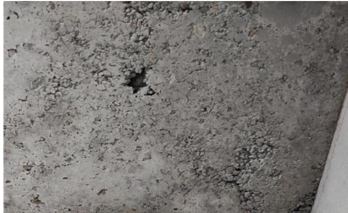
Figura 9 - Segregação do concreto.
