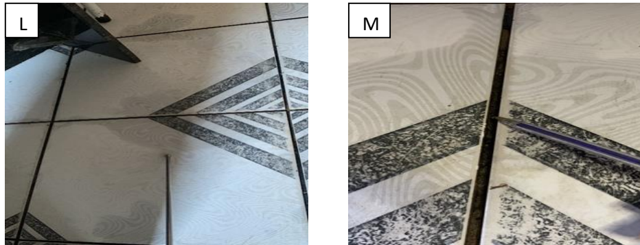
Figura 17 - Revestimento peças cerâmicos cozinha: L) Manchas umidade e peças ocas , M) ausência de rejunte
