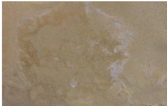
Figura 8 - Presença de eflorescência na alvenaria Fonte: Maia, 2018
