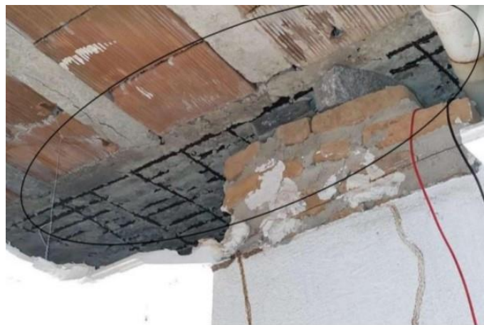
Figura 4 - Corrosão da armadura
