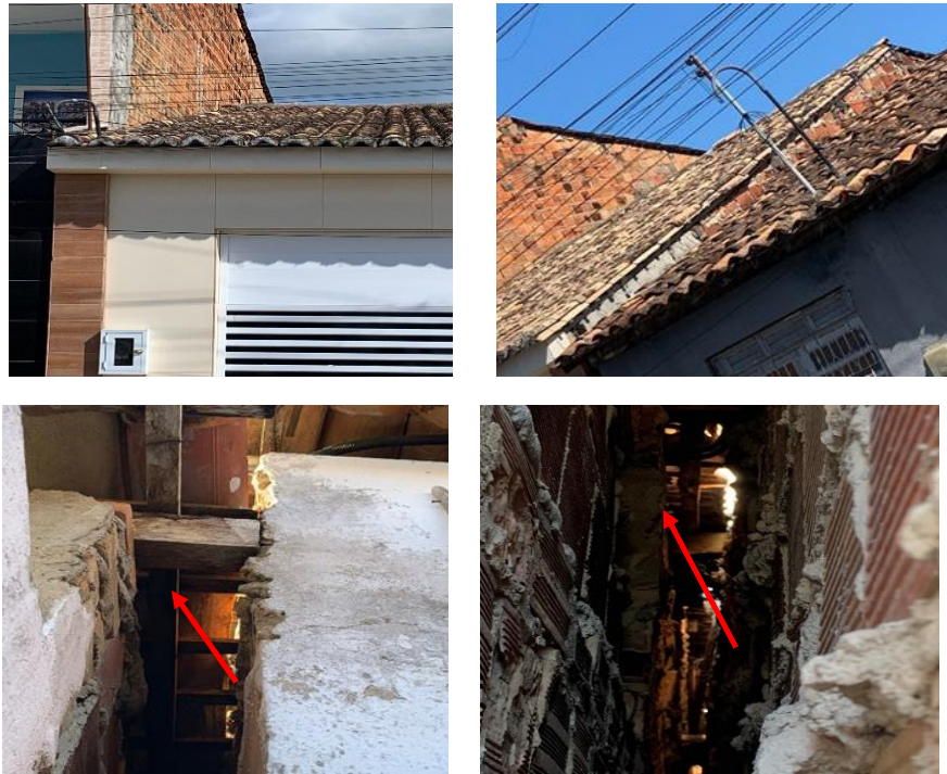
Figura 18 - Divisa com alvenaria vizinhas Fonte: Autor (2025)
