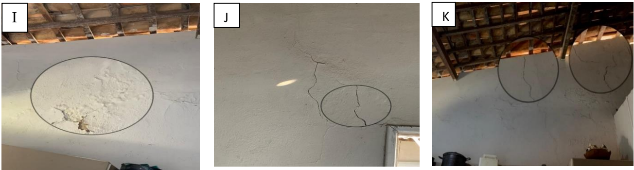
Figura 16 - Alvenaria da cozinha: I) Deterioração e descascamento da pintura, J) trincas e K) Fissuras verticais
