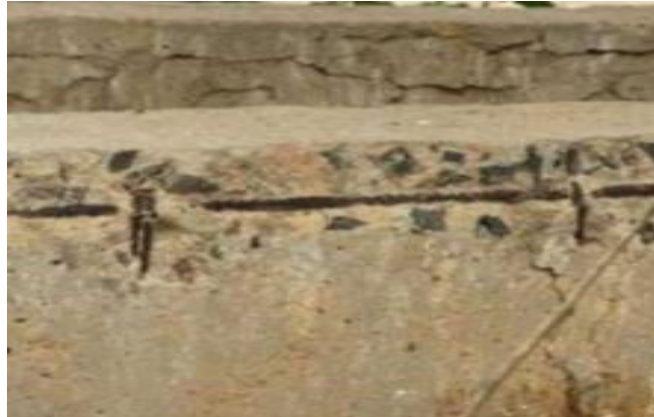
Figura 5 - Deslocamento do cobrimento Fonte: Batista, 2022
